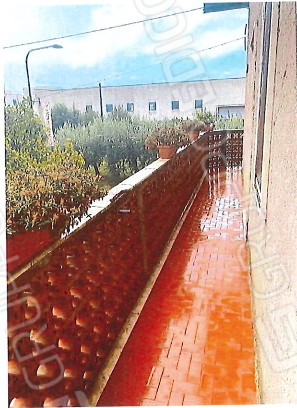
Foto 13 – Dettaglio del balcone lato SUD del sub 5 della particella 345
