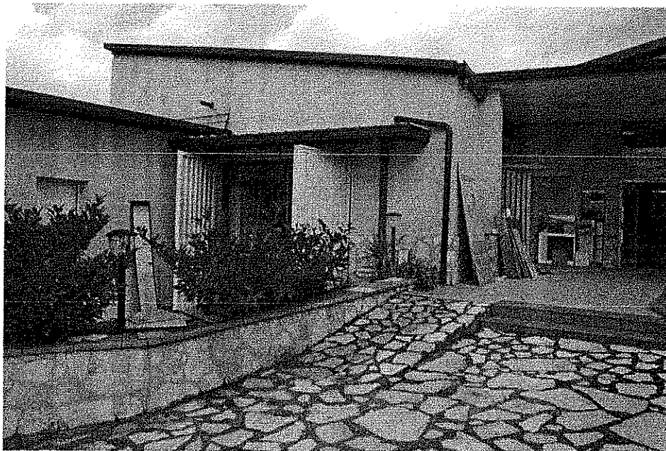
Foto 12 – Fabbricato abusivo: lato anteriore
