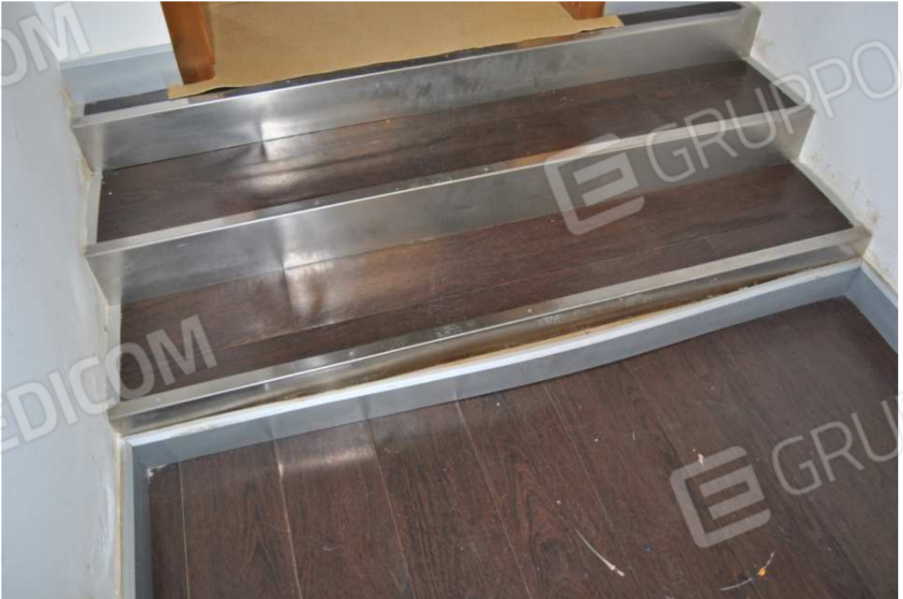
Foto 22 – 21.01.2016 – Fabbricato p.la 442 area amministrativa/commerciale: distacco del battiscopa
