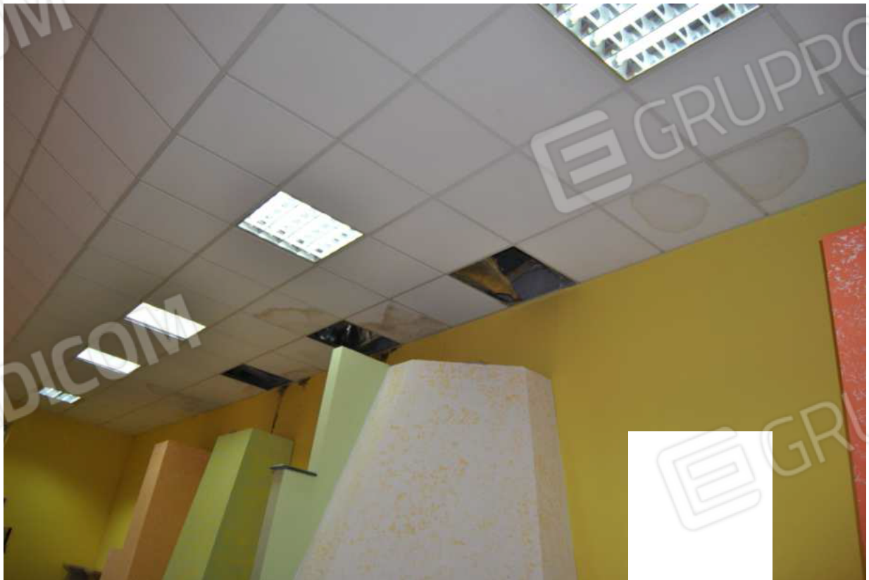
Foto 48 – 21.01.2016 – Area espositiva nel volume abusivo: vista della controsoffittatura con pannelli mancanti e fenomeni di muffa
