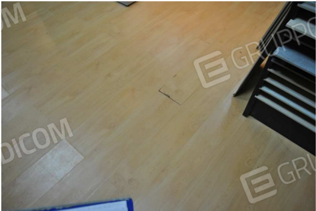
Foto 42 – 21.01.2016 – Area espositiva nel volume abusivo: deterioramento e sollevamento del parquet lungo le linee di fuga dei listoni
