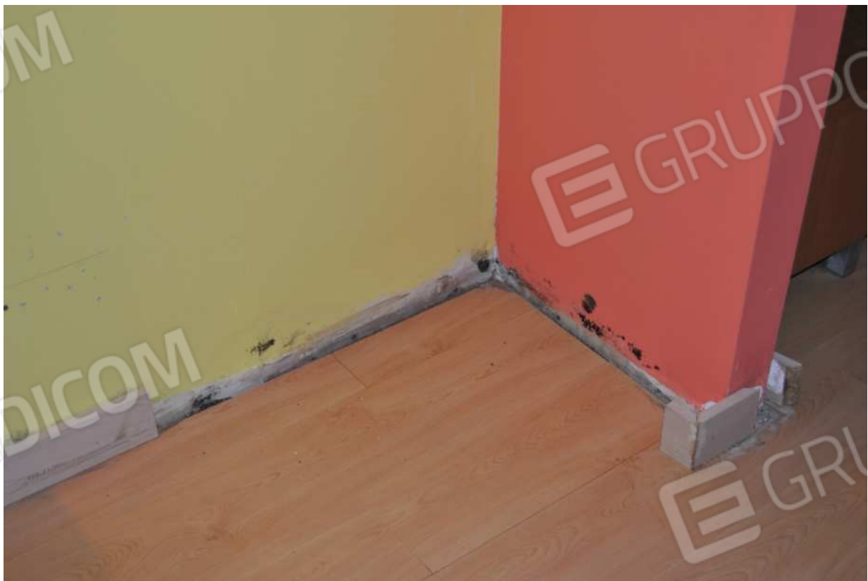
Foto 30 – 21.01.2016 – Fabbricato p.la 443 area espositiva: sollevamento del parquet lungo le linee di fuga dei listoni; distacco del battiscopa; deterioramento, rigonfiamento e screpolatura della pittura della parete, fenomeni di muffa
