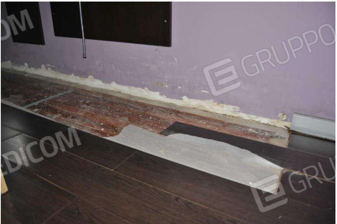
Foto 18 – 21.01.2016 – Fabbricato p.lla 442 area amministrativa/commerciale: altra vista dello scollamento e distacco del parquet, distacco del battiscopa, deterioramento, rigonfiamento e screpolatura della pittura della parete
