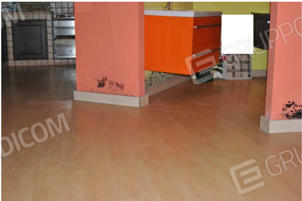
Foto 34 – 21.01.2016 – Fabbricato p.lla 443 area espositiva: sollevamento del parquet lungo le linee di fuga dei listoni; deterioramento, rigonfiamento e screpolatura della pittura della parete, importanti fenomeni di muffa
