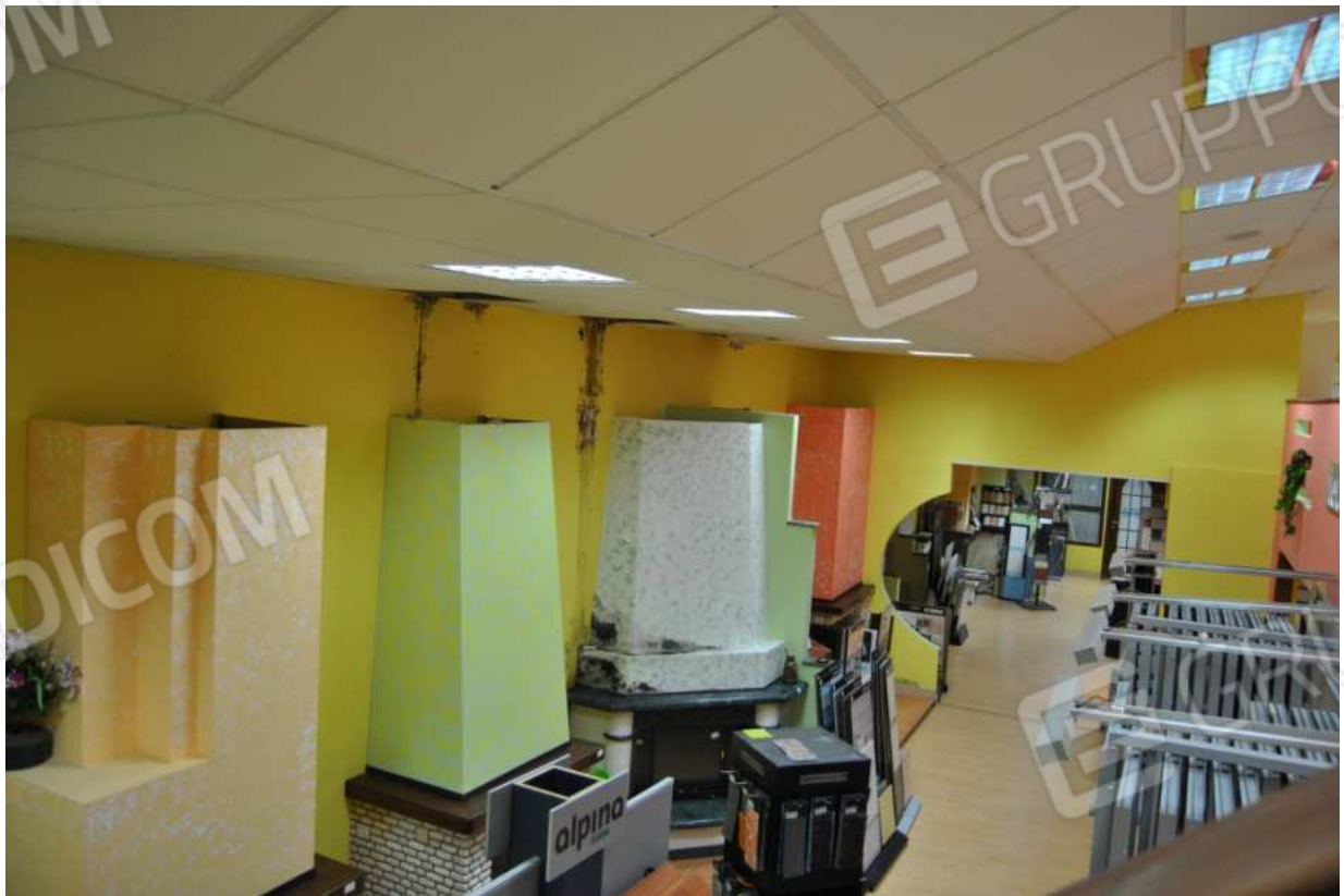
Foto 50 – 21.01.2016 – Area espositiva nel volume abusivo: vista della controsoffittatura con pannelli mancanti ed importanti fenomeni di muffa
