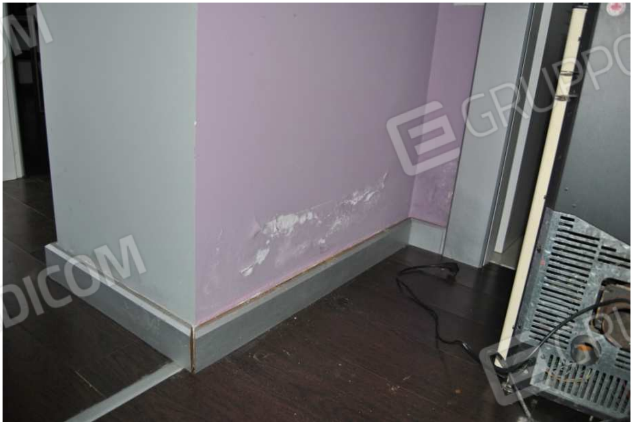
Foto 20 – 21.01.2016 – Fabbricato p.la 442 area amministrativa/commerciale: deterioramento, rigonfiamento e screpolatura della pittura della parete, fenomeni di muffa
