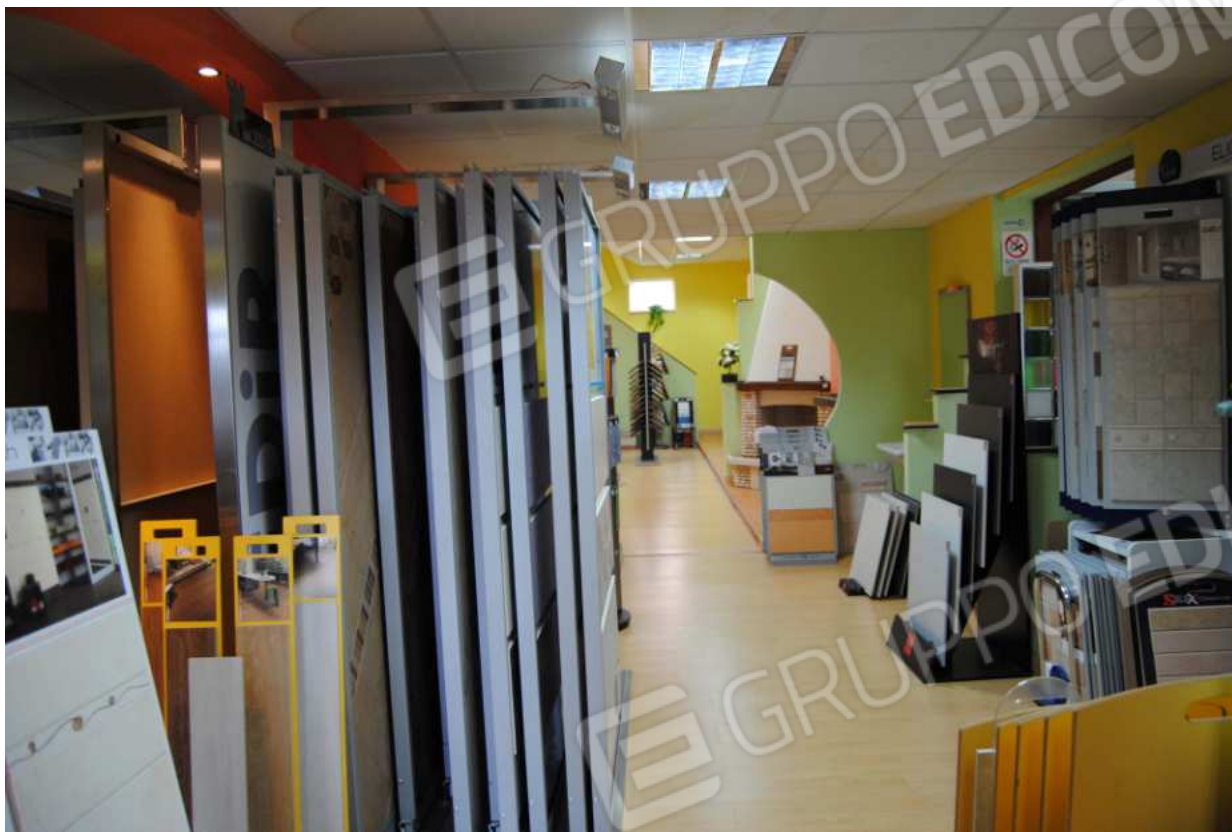
Foto 35 – 27.09.2010 – Area espositiva nel volume abusivo: da notare tracce di umidità su alcuni dei pannelli della controsoffittatura
