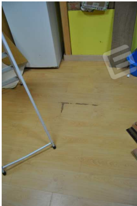
Foto 46 – 21.01.2016 – Area espositiva nel volume abusivo: deterioramento e sollevamento del parquet lungo le linee di fuga dei listoni
