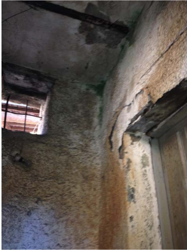
14) FOTO PIATTABANDE AMMALORATE
