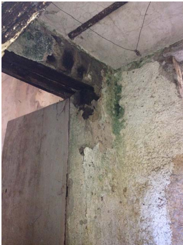
15) FOTO PIATTABANDA E SOLAIO IN FERRO
