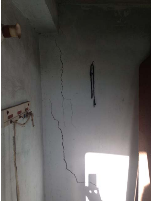
16) PARTICOLARE LESIONI INTERNE
