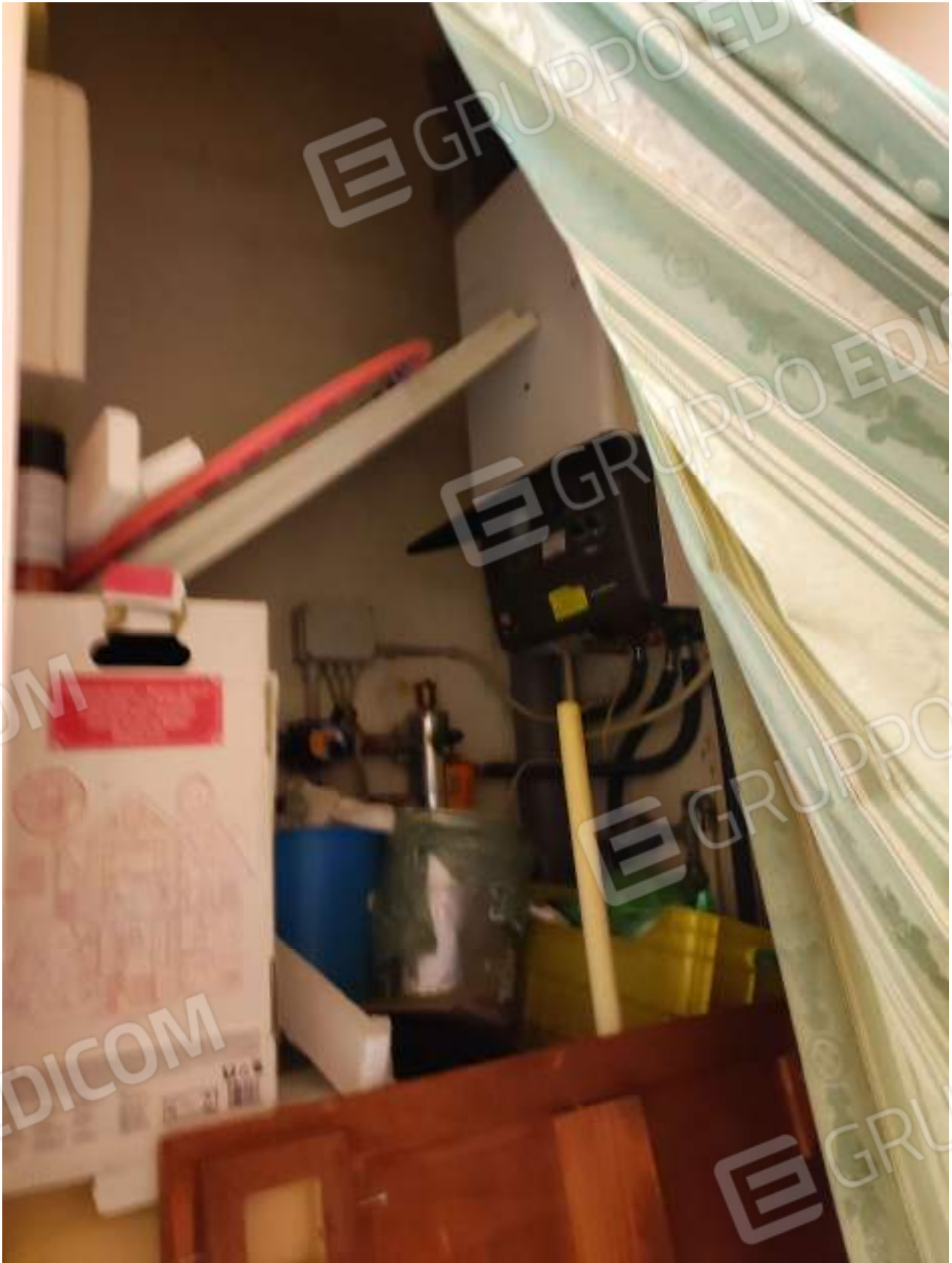
Foto 36 Centrale Termica (Piano Seminterrato)
