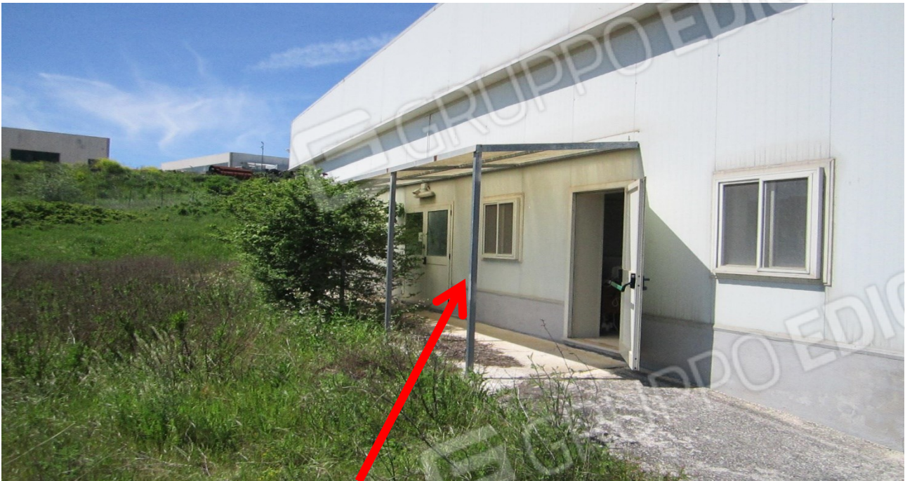
Tettoia realizzata in profilati in ferro e copertura in plexiglas in assenza di autorizzazione
