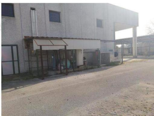
foto 45: ... impianto di climatizzazione
