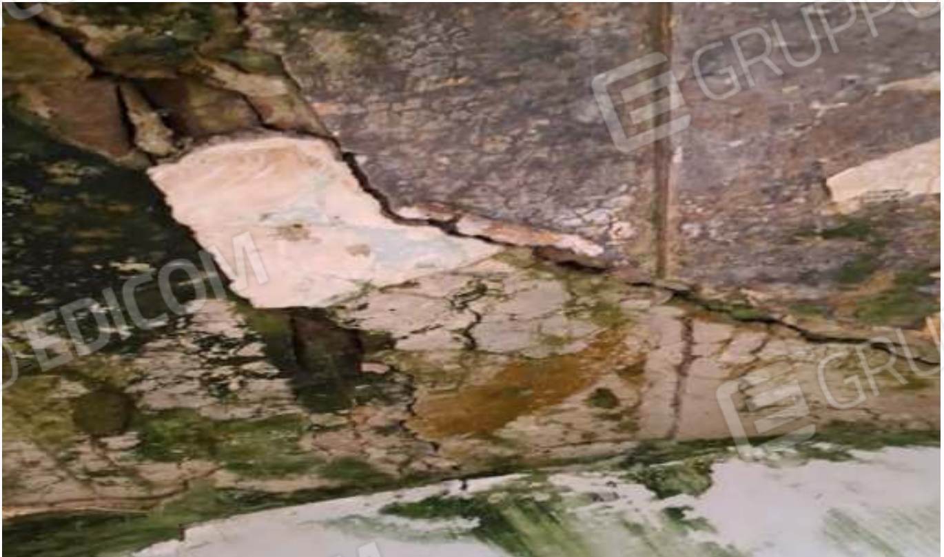
FOTO N. 14 VISTA INGRANDITA DEL DEGRADO DELLA VOLTA DEL LOCALE LETTO 1
