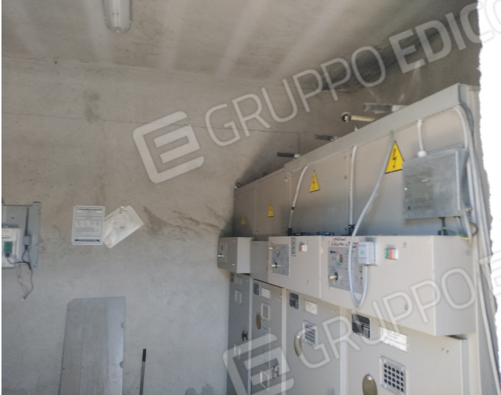
VANO CABINA ENEL
