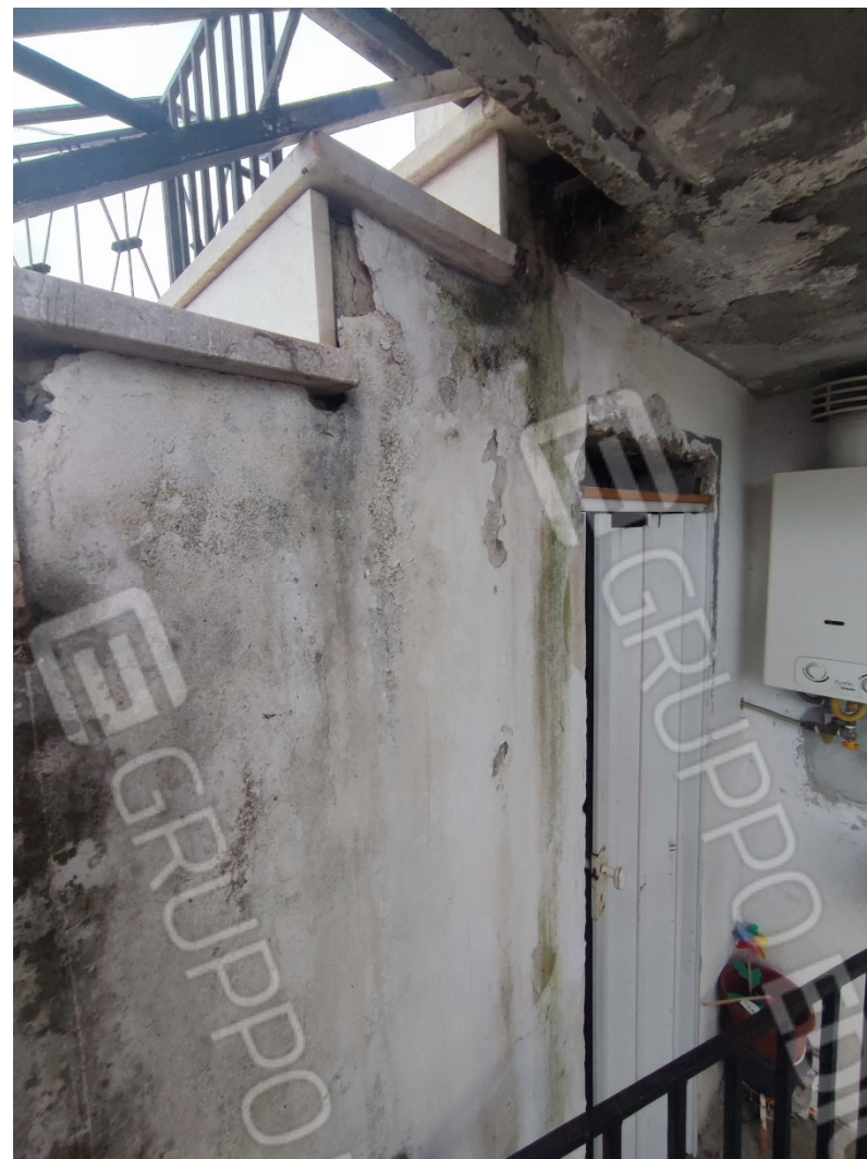
Evidenti segni di infiltrazione che hanno generato il distacco di intonaco
