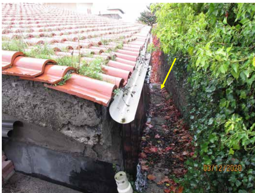
Fotografia 18 – Terrapieno addossato al prospetto nord dell'edificio pignorato.
