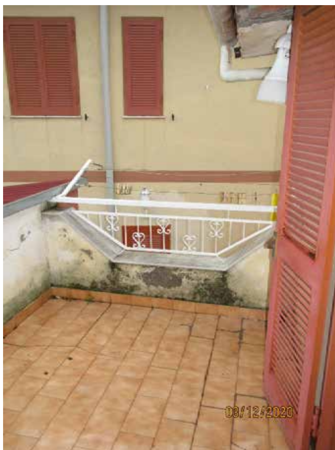
Fotografia 44 – Terrazzino: Lungo il perimetro è presente un muretto di protezione rivestito da intonaci ordinari e tinteggiato con pittura al quarzo, sormontato da una ringhiera in ferro. Ad ovest affaccia sul cortile comune e a sud affaccia sul solaio di copertura del “Soggiorno/Pranzo”, mentre ad est è delimitato dal vano finestra che immette nel vano della “Scala interna”.
