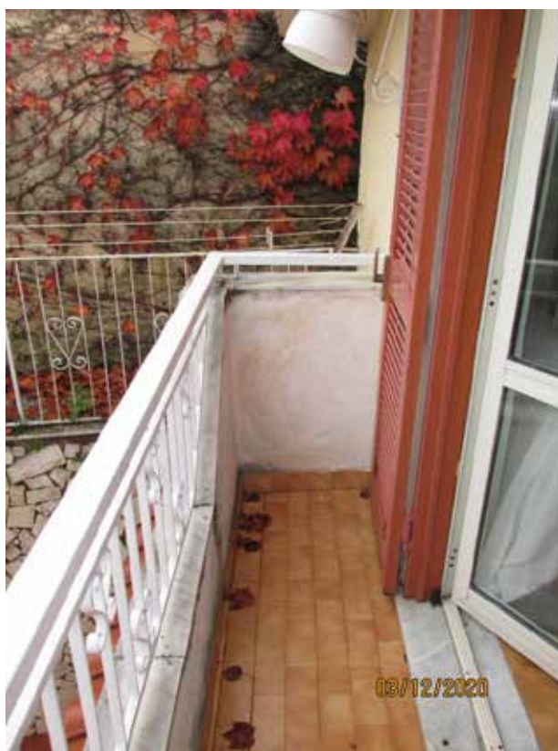
Fotografia 51 – Balcone: Risulta pavimentata per tutta la sua superficie da piastrelle in ceramica smaltata ed è protetto dall'esterno da un muretto rivestito da intonaci ordinari e tinteggiato con pittura al quarzo, sormontato da una ringhiera in ferro.
