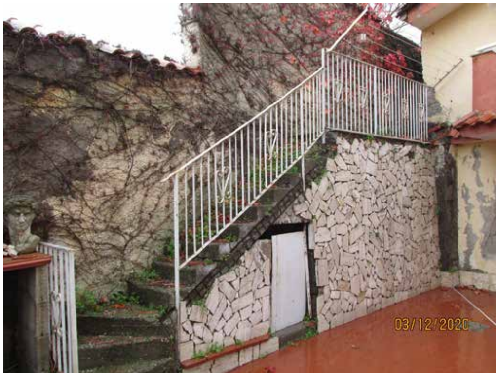
Fotografia 20 – Il terrapieno è accessibile tramite una scala esterna in muratura, munita di ringhiera in ferro, posta sul confine nord del cortile comune.
