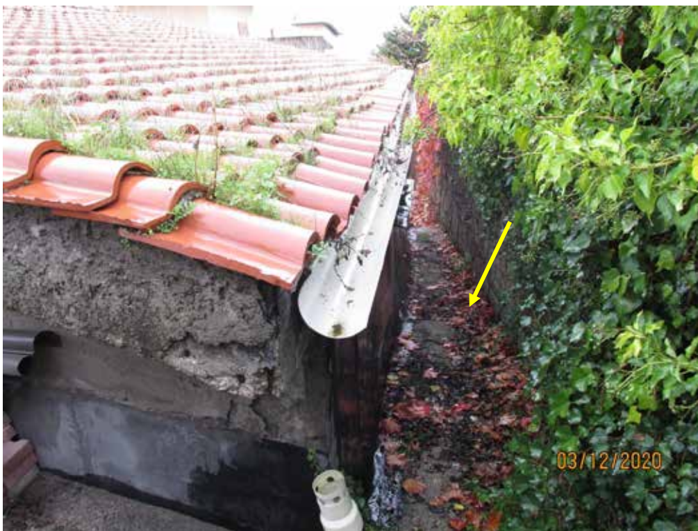
Fotografia 18 – Terrapieno addossato al prospetto nord dell'edificio pignorato.
