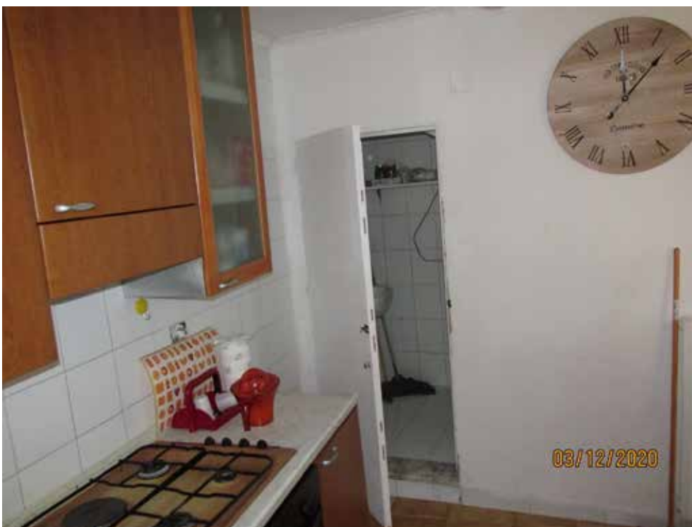
Fotografia 32 – Bagno 1: vi si accede dalla "Cucina" è ubicato sotto la scala che conduce al piano superiore e occupa una superficie utile netta pari a mq. 2,48, ha un'altezza interna dal piano di calpestio variabile che va da un massimo di ml. 2,40 ad un minimo di ml. 1,10.
