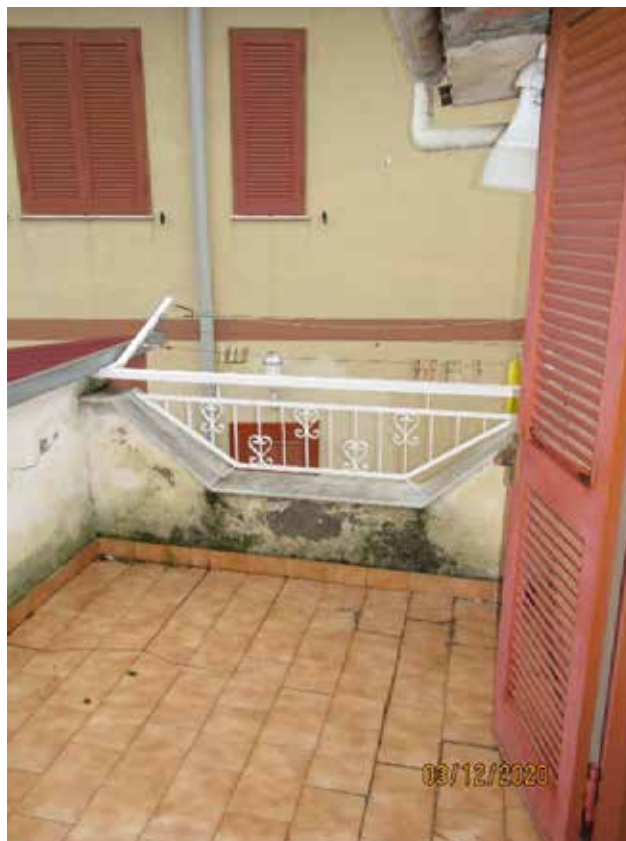
Fotografia 44 – Terrazzino: Lungo il perimetro è presente un muretto di protezione rivestito da intonaci ordinari e tinteggiato con pittura al quarzo, sormontato da una ringhiera in ferro. Ad ovest affaccia sul cortile comune e a sud affaccia sul solaio di copertura del “Soggiorno/Pranzo”, mentre ad est è delimitato dal vano finestra che immette nel vano della “Scala interna”.
