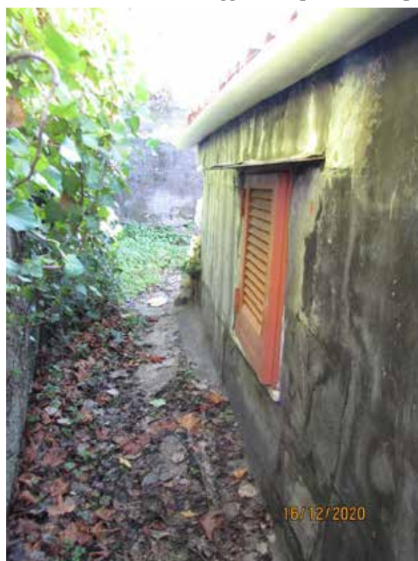
Fotografia 54 – Bagno 2: Il bagno, lungo la parete nord, è dotato di finestra dotata di infisso in alluminio con vetro camera protetto all'esterno da un infisso in ferro di tipo “persiana alla napoletana”.
