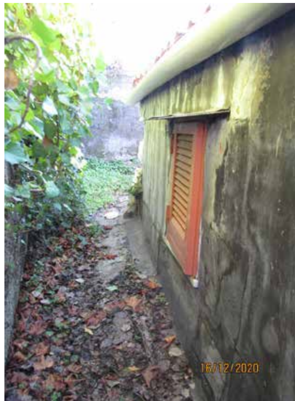
Fotografia 54 – Bagno 2: Il bagno, lungo la parete nord, è dotato di finestra dotata di infisso in alluminio con vetro camera protetto all'esterno da un infisso in ferro di tipo “persiana alla napoletana”.
