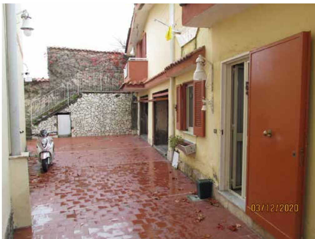
Fotografia 24 – Gli infissi esterni dell’appartamento sono costituiti da serramenti in ferro di tipo “persiane alla napoletana” con retrofinestre in alluminio e vetro camera, mentre il portoncino d’ingresso è dotato di portoncino blindato e di retroinfisso in alluminio e vetro camera; il locale deposito ed il locale box, sono invece dotati all’ingresso da serramenti di tipo “basculanti” in ferro.
