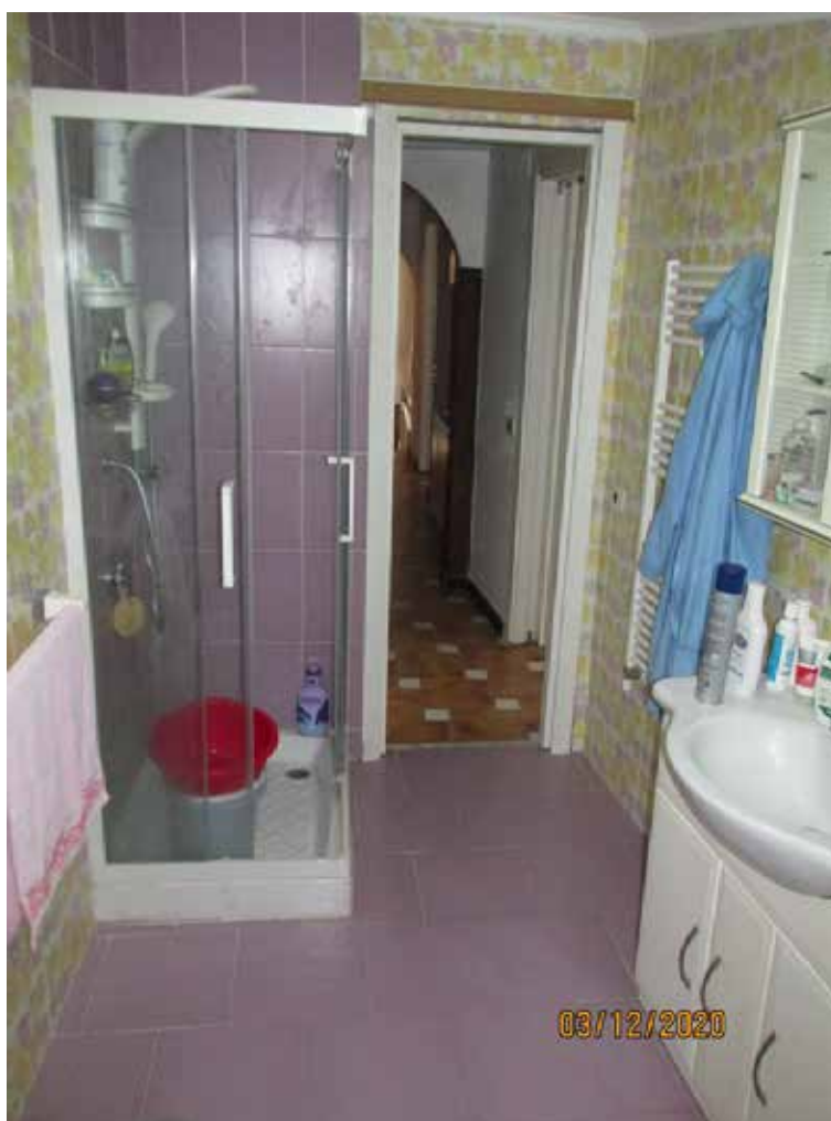
Fotografia 52 – Bagno 2: Vi si accede dal “ Corridoio ”, occupa una superficie utile netta pari a mq. 6,18 e un’altezza media dal piano di calpestio pari a ml. 2,20. L’ambiente è dotato di tazza igienica, lavabo, bidet e piatto doccia.
