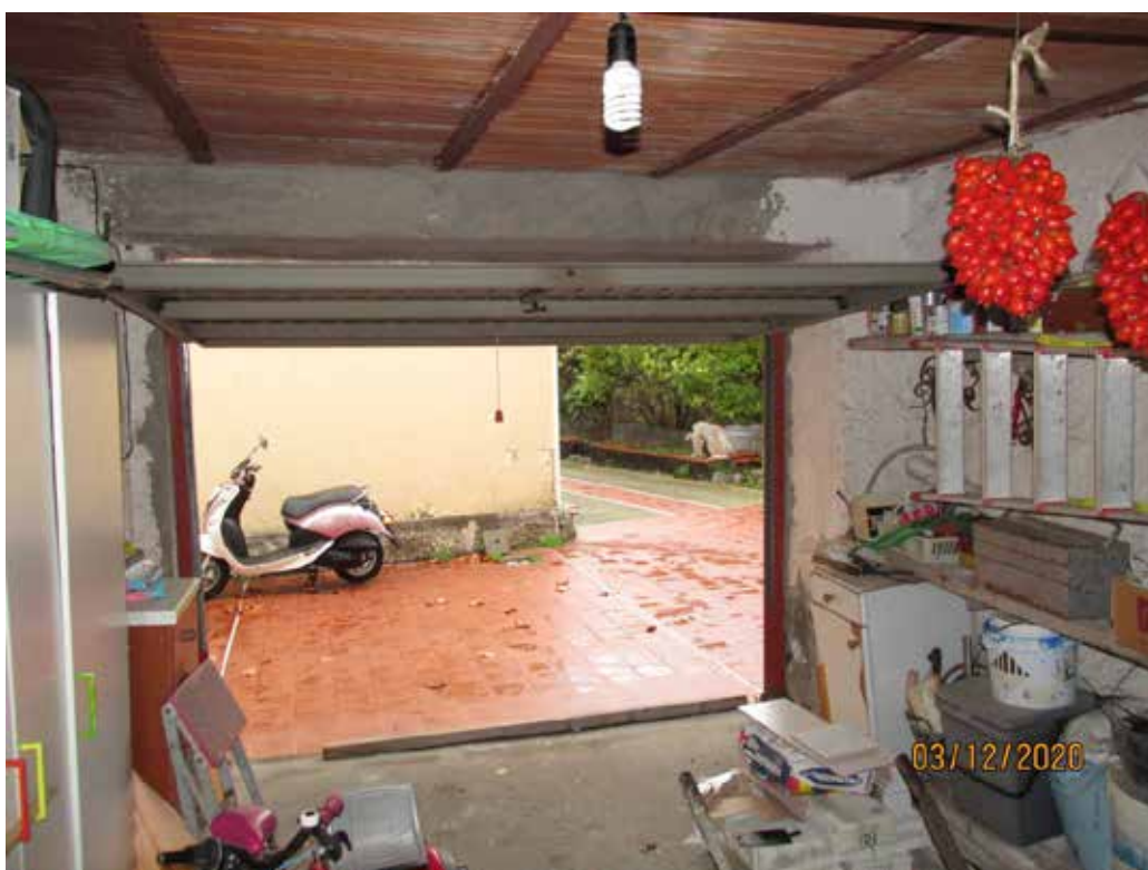
Fotografia 57 – Box auto: Il locale è privo di un impianto elettrico a norma, quello esistente è costituito da un cavetto per esterni fissato a parete, sono presenti una presa ed un punto luce centrale.
