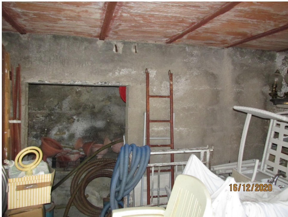
Fotografia 60 – Deposito: le pareti sono rifinite con intonaci ordinari a finitura rustica; il soffitto del solaio si presenta allo stato grezzo con l'orditura del solaio a vista. Il locale è privo di un impianto elettrico.
