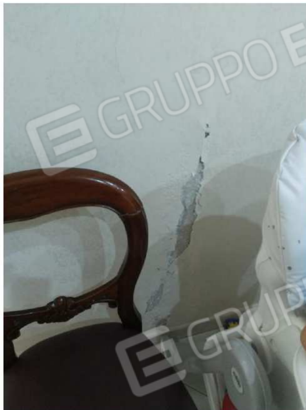
Foto 19 – Soggiorno/Pranzo - Particolare esfoliazione e distacco intonaco
