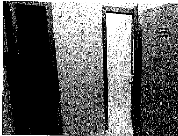
Bagni ubicati al PT in adiacenza al locale deposito nel lato est del fabbricato
