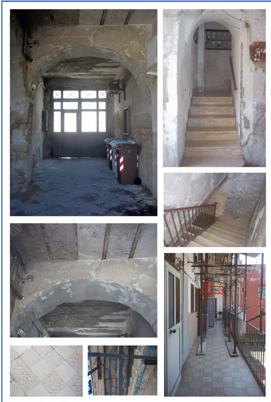
(Scatti fotografici che evidenziano la situazione di pessimo stato manutentivo rilevato)
