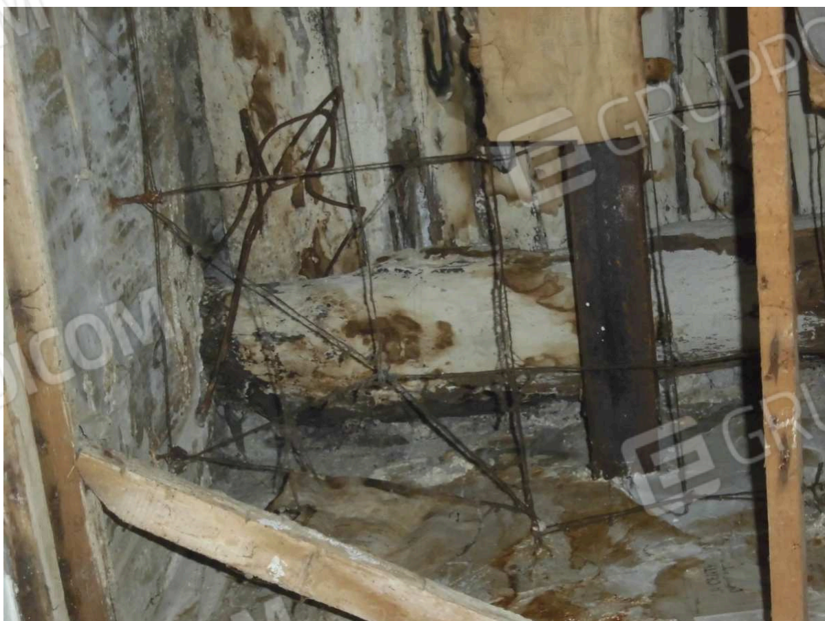
Foto n. 54: • Particolare della foto n. 53 (si vedono i vecchi solai in legno rinforzati con poutrelles ).
