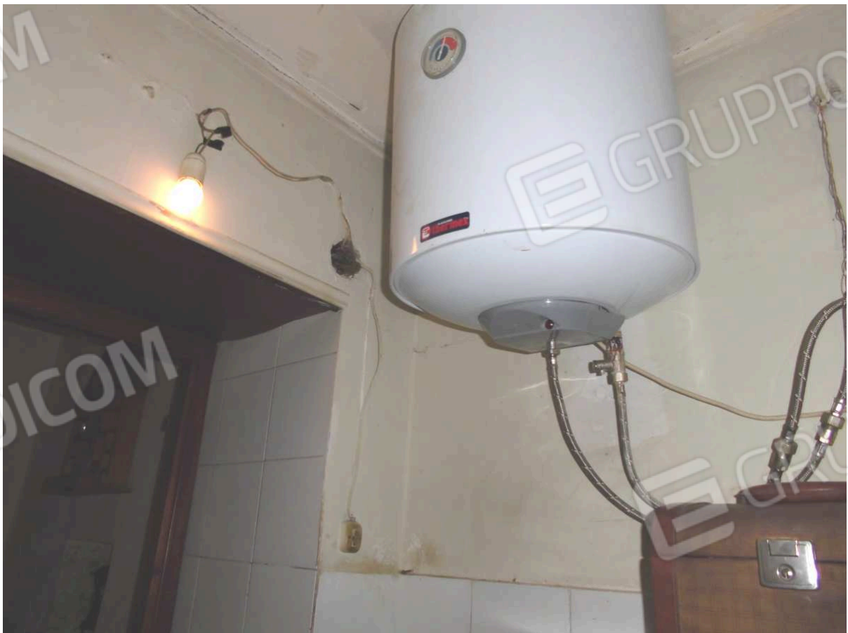
Foto n. 60: • Scaldabagno elettrico. • Si noti la "qualità" delle installazioni elettriche.
