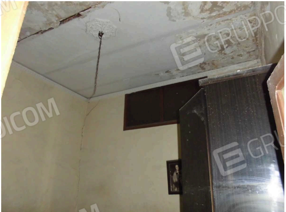
Foto n. 26: • Condizioni del soffitto nella camera di cui alla foto precedente.
