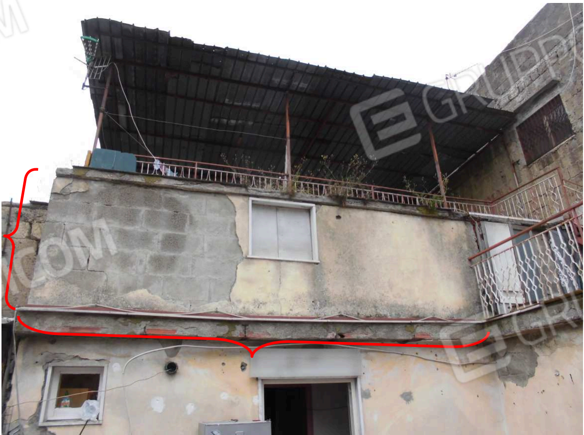
Foto n. 32: • E' stato evidenziato il manufatto corrispondente al locale in mezzanino. • La finestra asservita al locale è "cieca".
