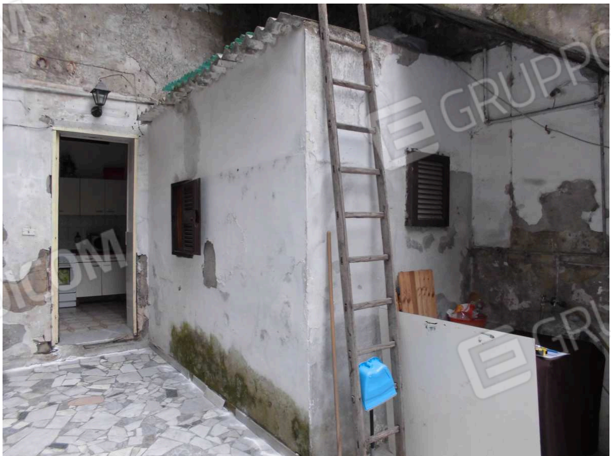
Foto n. 49: • Manufatto in ampliamento in cui sono attualmente allocati i locali del bagno. • Si notino le macchie verdastre alla base del paramento.
