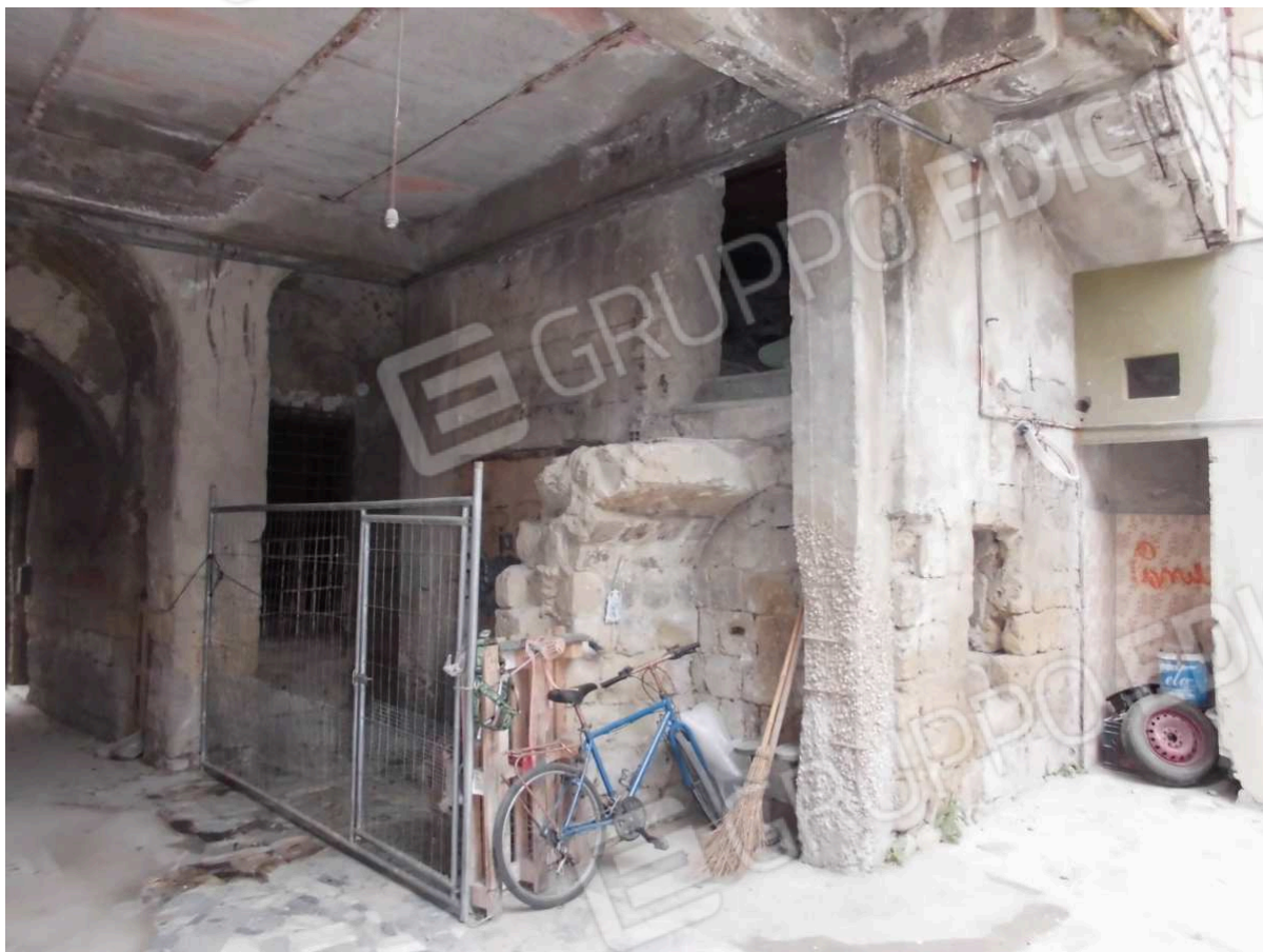
Foto n. 8: • Particolare della foto n. 7 (locali parzialmente diruti sottostanti l'androne d'ingresso).
