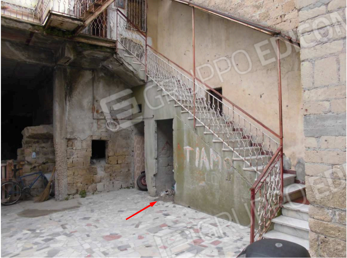
Foto n. 6: • Stessa scala di cui alla foto precedente (è stata evidenziata la porta del vano sottoscala).
