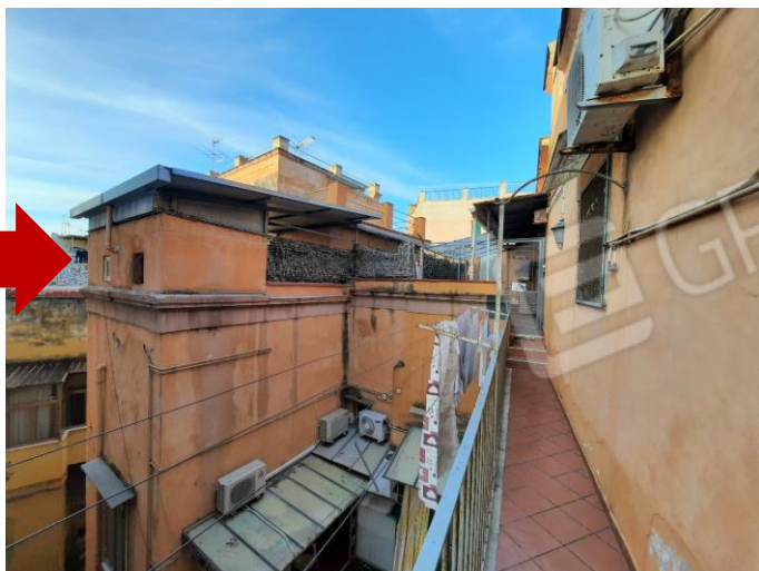
FOTO 22 VISTE DEL PASSETTO COMUNE DI ACCESSO AL TERRAZZO SCOPERTO COMUNE AI TRE ALLOGGI DEL SECONDO PIANO. VISTA DEL LOCALE DEPOSITO LAVANDERIA E DEL TERRAZZO COPERTO IN COMUNE CON IL SUB 8 CONFINANTE.
