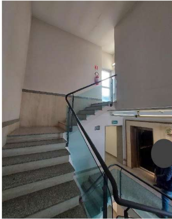
Rampe scale che conduce al piano dodicesimo e relativa porta di accesso
