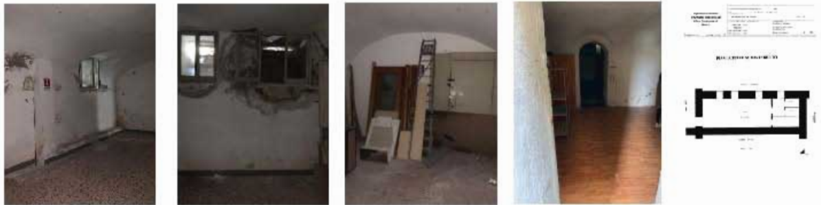
situazione interna dei locali e successiva DESCRIZIONE DEI DANNI
