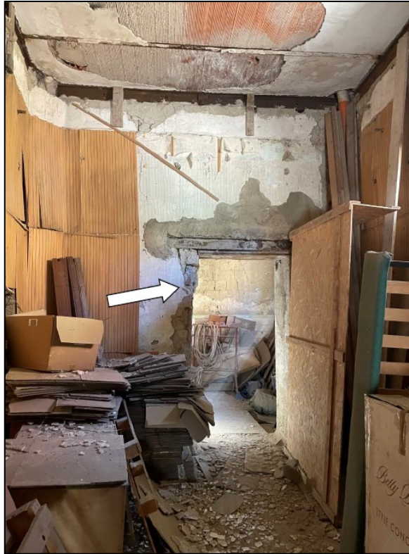
Stanza 2: foto tratta dalla relazione dell'ing. [REDACTED] vista seconda stanza con muro dissestato piattabanda e detriti solaio a terra
