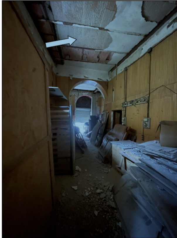
Stanza 2: foto tratta dalla relazione dell'ing. [REDACTED] solaio dissestato nella seconda stanza e relativi detriti a terra
