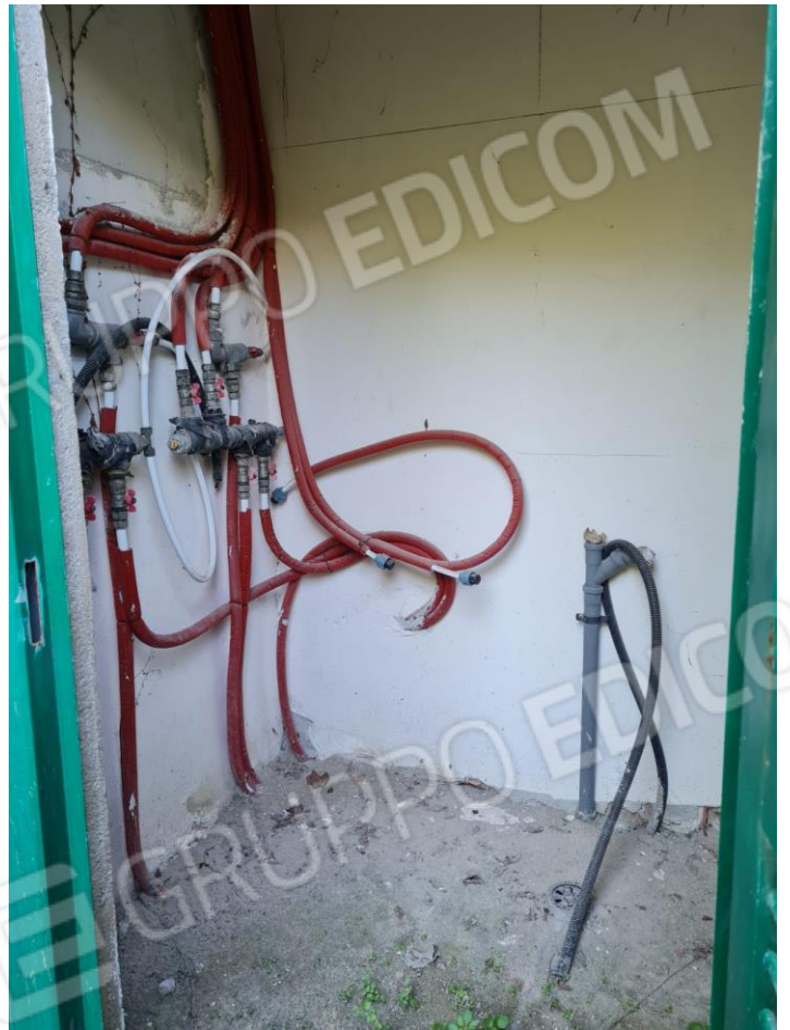
Locale Caldaia (LC)
