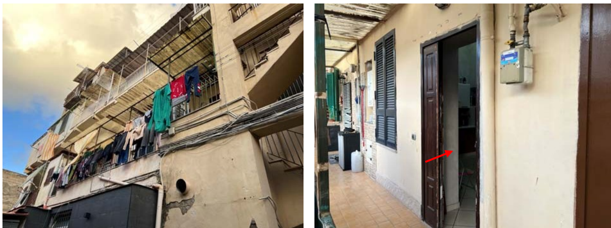
Vista dei ballatoi posteriori di disimpegno delle unità e dettaglio della porta di accesso all'unità staggita
