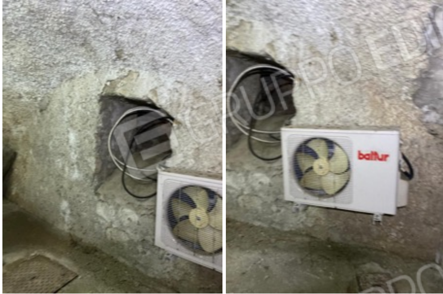
Foto da 39 a 40 : Vista motore area condizionata
