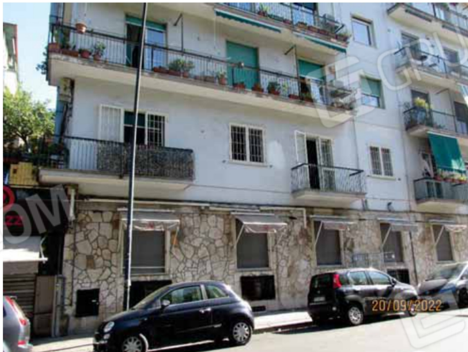
Fotografia 8 – Le chiusure d’ambito sono in muratura rivestite con intonaci ordinari e tinteggiate con pittura al quarzo, ad eccezione del prospetto al piano terra che affaccia sulla pubblica strada che risulta rivestito con lastre in marmo di media pezzatura posate ad “opus incerta”.
