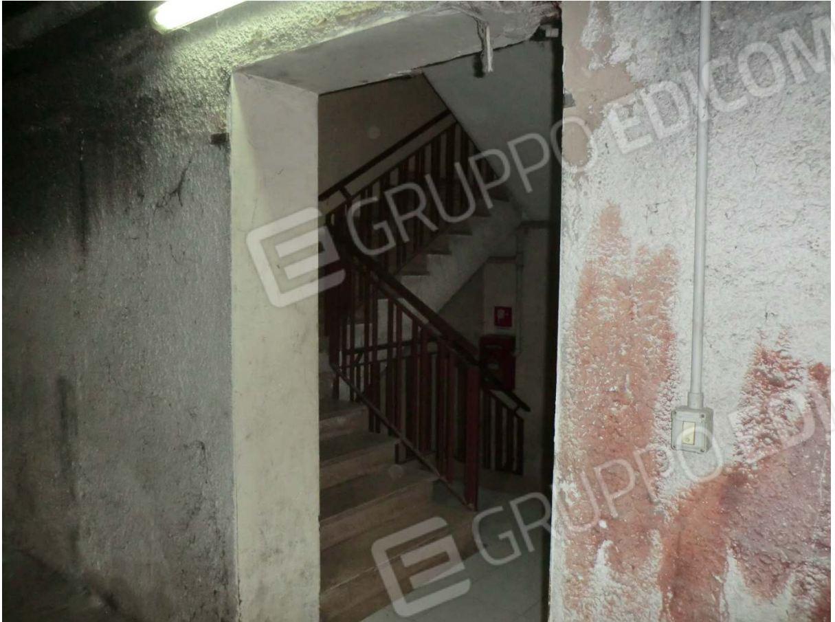
Foto 29: • Varco di accesso al primo piano interrato dalla scala asservita al fabbricato in elevazione.
