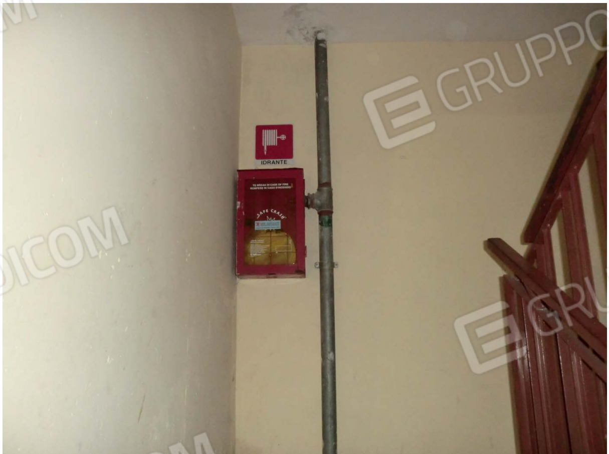
Foto 8: • Impianto antincendio asservito al fabbricato comprendente gli immobili pignorati.
