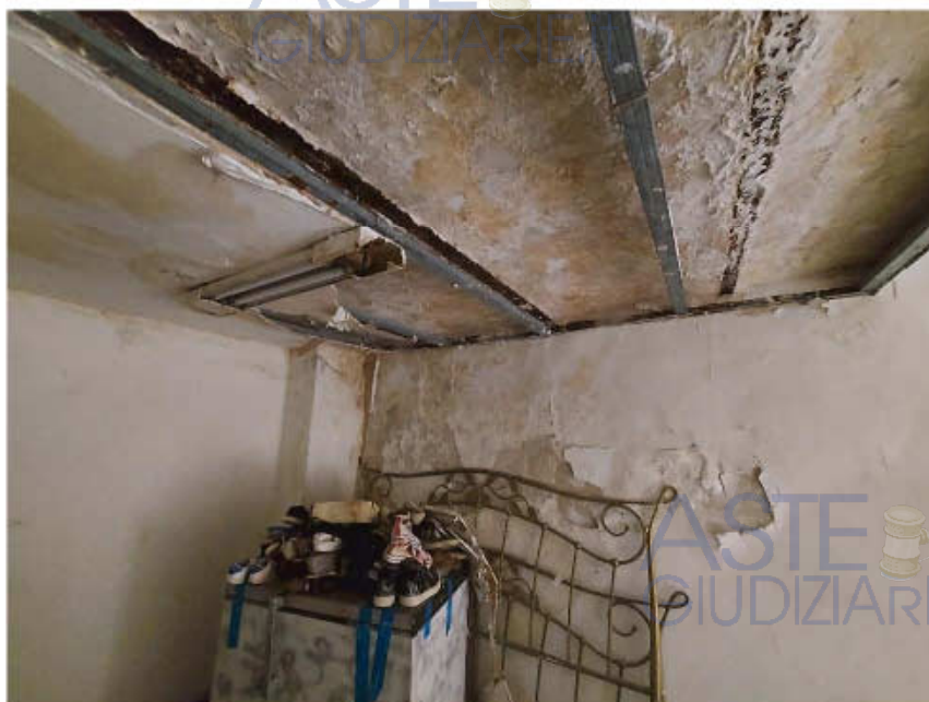
Part. piano soppalco – evidenti tracce di fenomeni infiltrativi sul solaio del disimpegno
