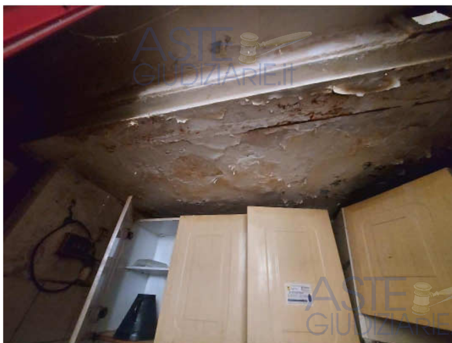
Part. piano di accesso cespite – evidenti tracce di fenomeni infiltrativi sul solaio dell'angolo cottura
