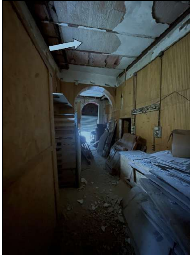
Stanza 2: foto tratta dalla relazione dell'ing. [REDACTED] solaio dissestato nella seconda stanza e relativi detriti a terra
