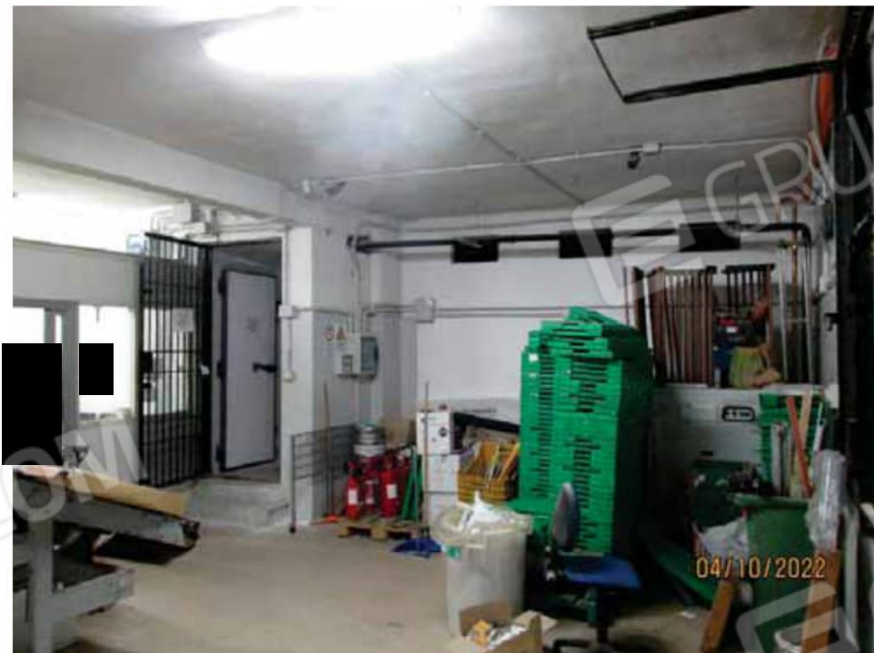
Fotografia 26 – Locale 2/a Sub 102: le pareti risultano interamente rivestite con piastrelle in ceramica smaltata, ad eccezione della parete di confine con il “Locale 2/b Sub 102” che risulta rivestita con intonaci ordinari a finitura liscia e tinteggiata con pittura lavabile.
