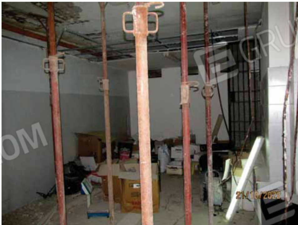
Fotografia 38 – Locale 2/b Sub 102 : Il solaio presenta serie carenze strutturali, la struttura portante del solaio costituita da travetti in c.a. gettati in opera, presenta la parte corticale ormai assente in più punti dovuta principalmente all'avanzato stato di ossidazione dei ferri di armatura che in alcuni tratti appaiono addirittura assenti. Tale stato di fatto, a giudizio dello scrivente, compromette l'agibilità e la praticabilità del locale.
