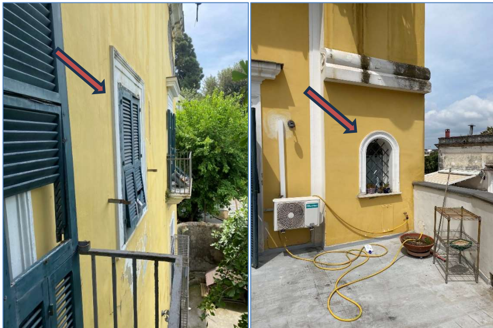
Figura 9. Finestra salone [#2] sul prospetto ovest e finestra bagno [#11] sul prospetto est.
