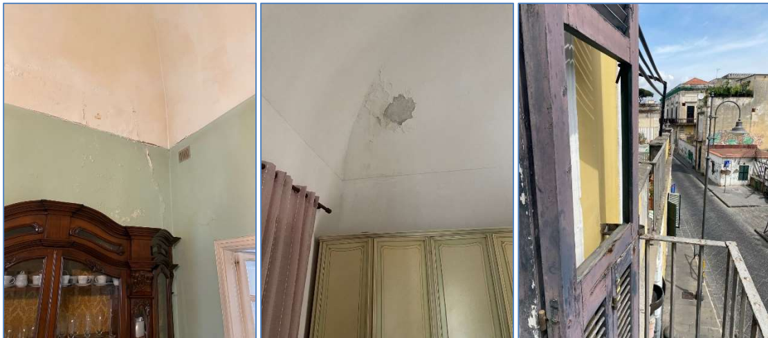
Figura 7. Particolare delle infiltrazioni del soffitto nel primo salone e nella camera. Particolare delle persiane.
