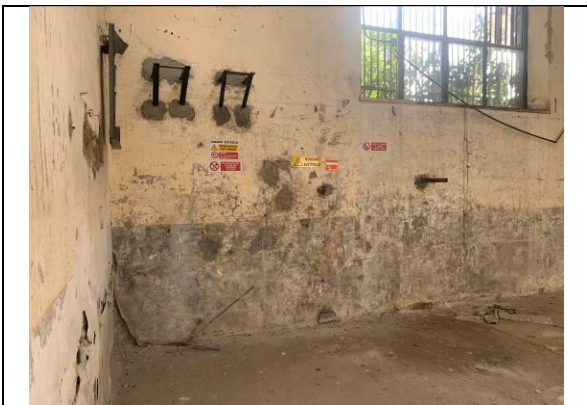
Immagine n. 15 - Dettaglio degrado pareti
