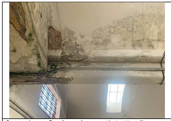
Immagine n. 8 - Ammaloramenti strutturali
