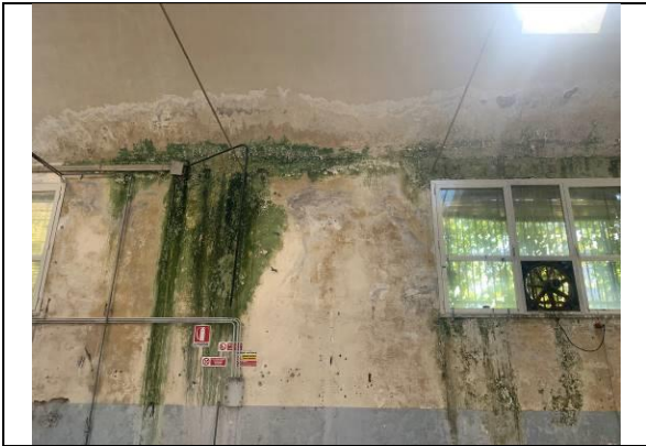
Immagine n. 17 – Dettaglio stato di degrado
