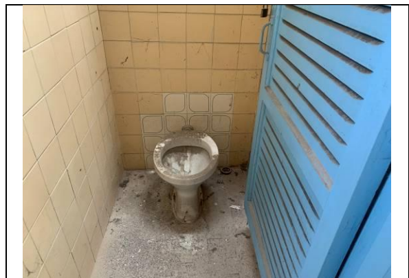
Immagine n. 24 – Dettaglio degrado bagno
