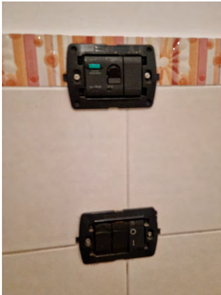
Particolare impianto elettrico
