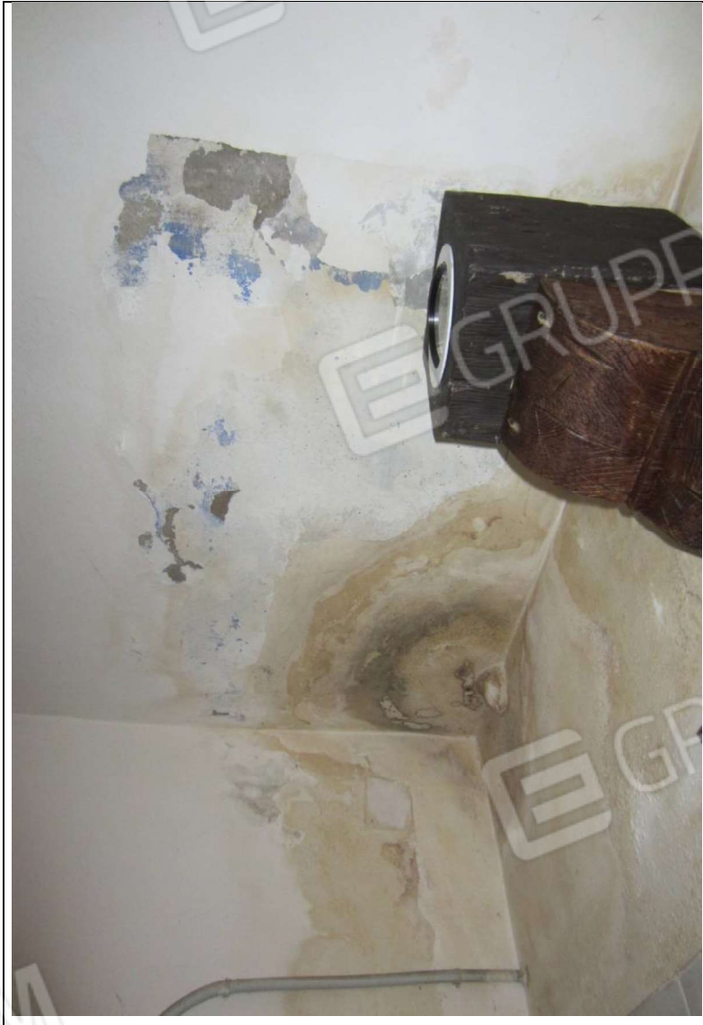
INFILTRAZIONI SOFFITTO BAGNO P. TERRA
