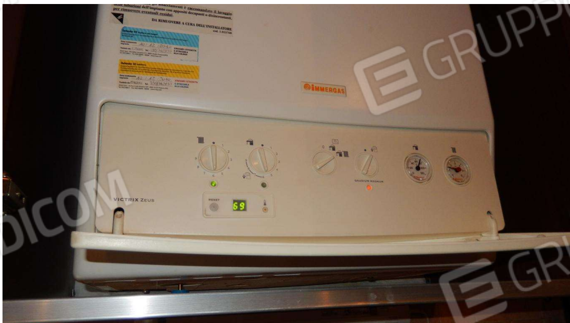
PARTICOLARE CALDAIA IN CUCINA
