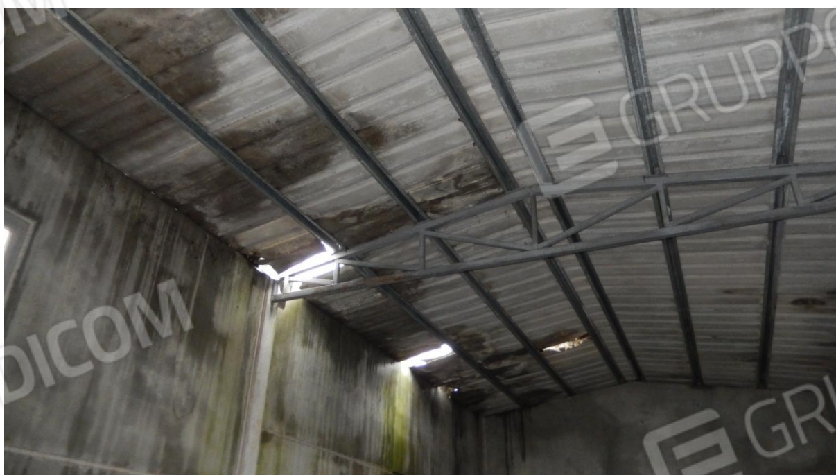
PARTICOLARE COPERTURA E DANNI (ANNOSI) DA FORTUNALE
