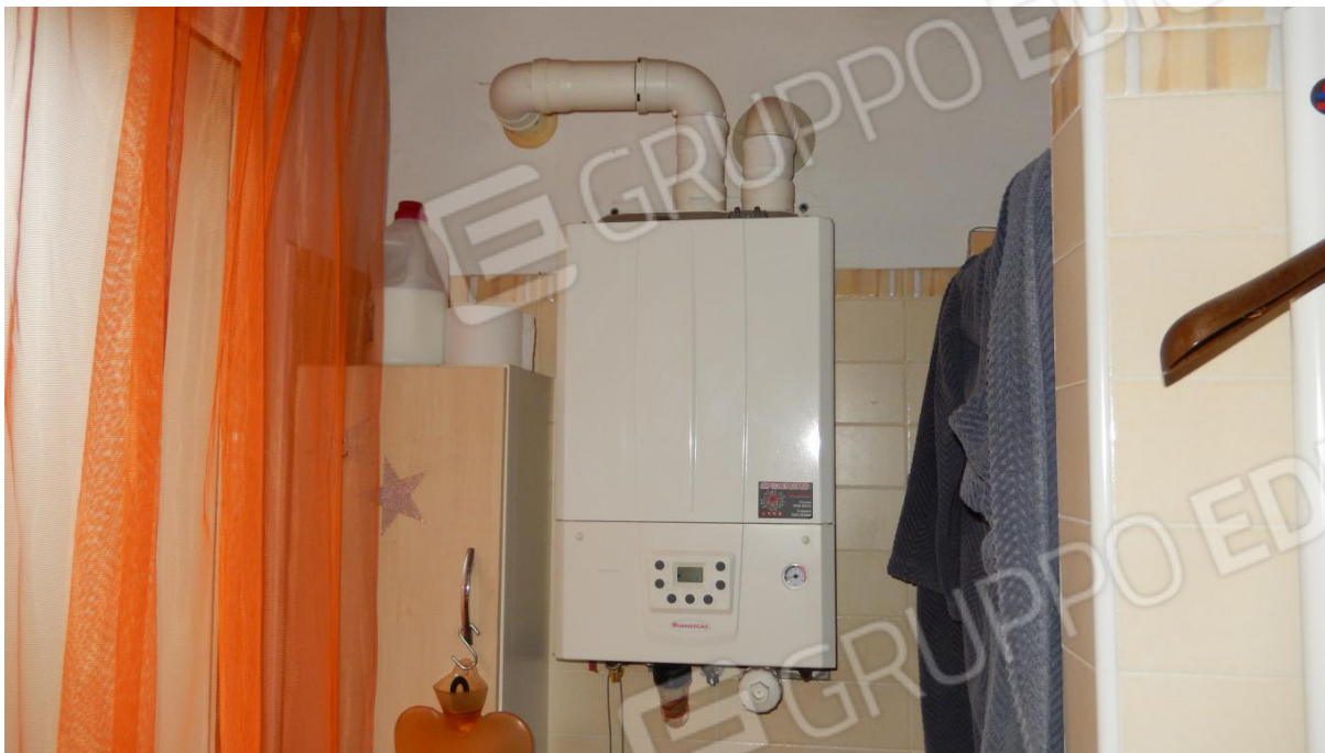
PARTICOLARE CALDAIA AUTONOMA PER RISCALDAMENTO NEL BAGNO DEL P.T.
