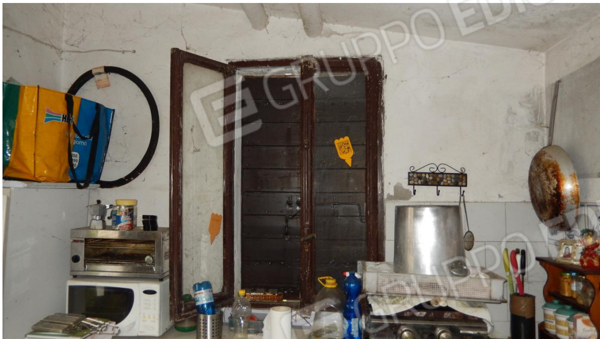
PARTICOLARE INTERNO LOCALE EX LAVANDERIA (MOLTO VETUSTO)
