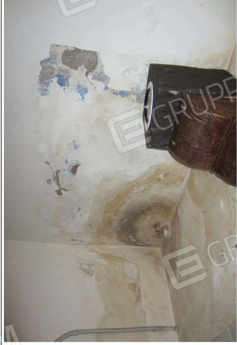
INFILTRAZIONI SOFFITTO BAGNO P. TERRA
