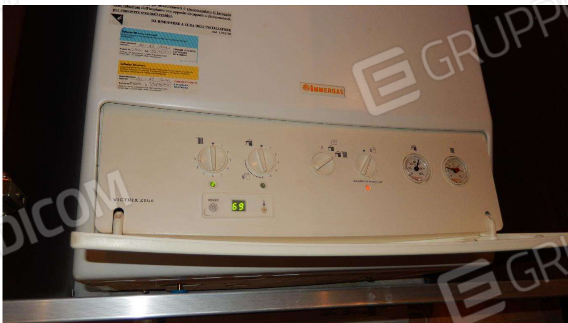
PARTICOLARE CALDAIA IN CUCINA
