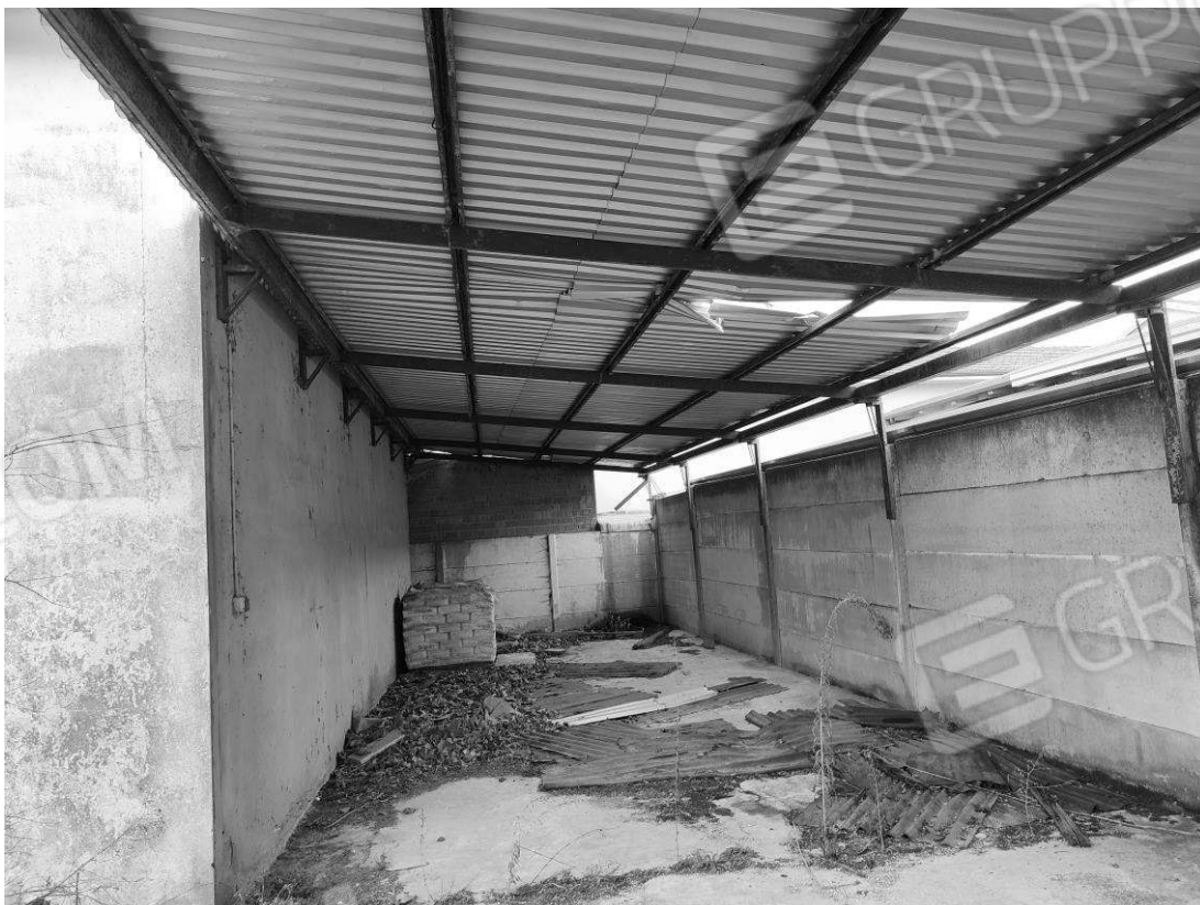
FOTO 14 – tettoia irregolare da rimuovere
