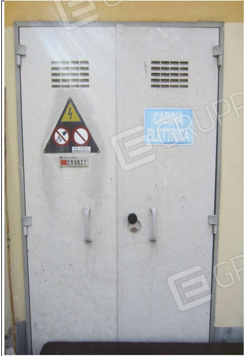
AREA URBANA MAPP. 237 SUB 1 (E SOVRASTANTE CABINA ELETT.)
