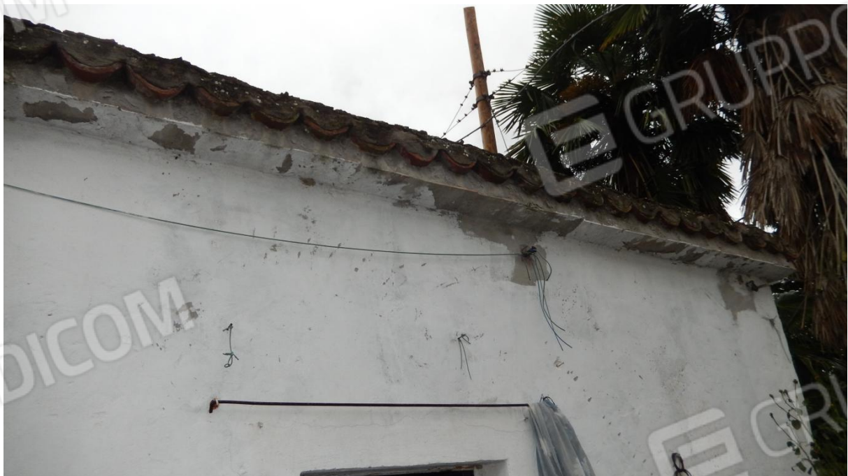
PARTICOLARE COSTRUTTIVO EX LAVANDERIA INFILTRAZIONI PER ASSENZA GRONDAIE E GRMBIALINE
