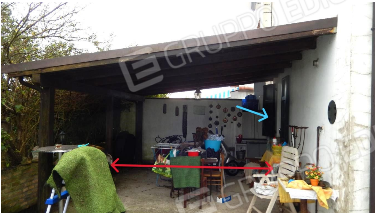
TETTOIA LATO SUD DIFFORME DA RIMUOVERE ANCHE PERCHE' COSTRUITA SU TERRENO DI TERZI ACCORPATO IMPROPRIAMENTE E FINESTRA LOCALE P.T. APERTA ABUSIVAMENTE
