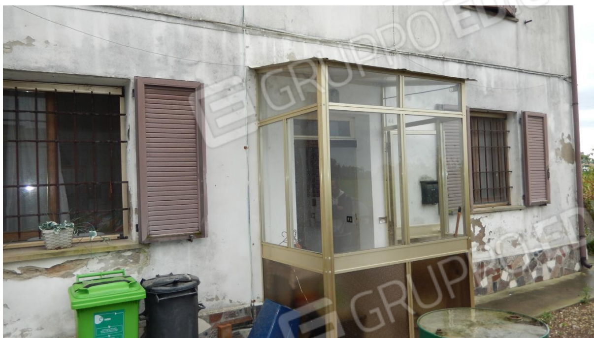
PARTICOLARE BUSOLA INGRESSO CIV (DIFFORME DA RIMUOVERE)
