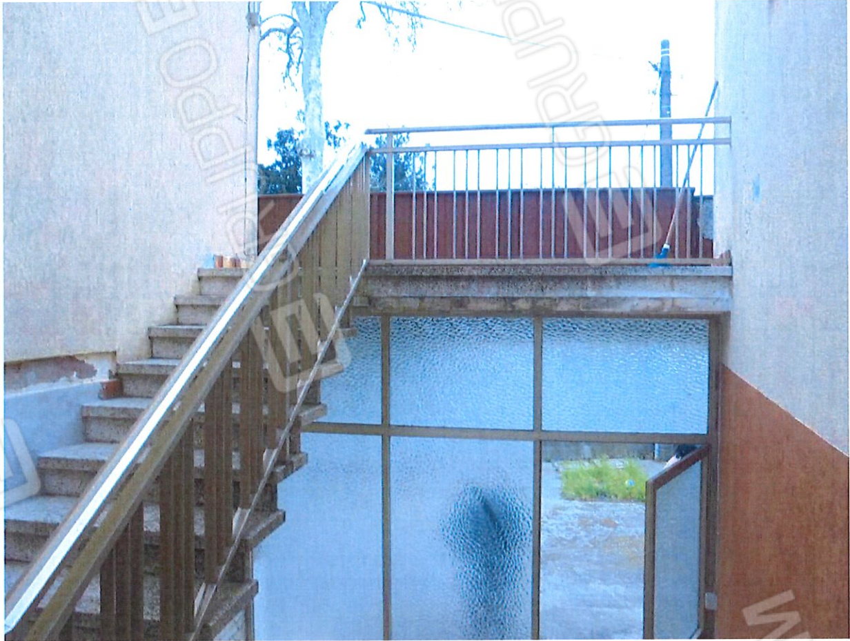
Foto 6. Particolare della scala di accesso al piano primo in comune con il lotto 5).
