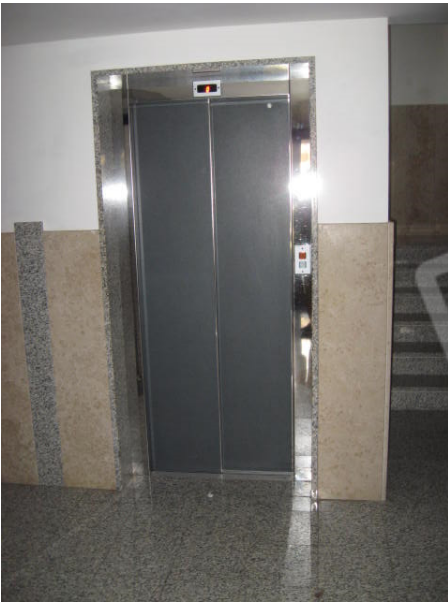
Vista ascensore e ingresso comune
