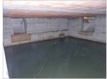
FOTO 39 - PIANO INTERRATO RISTAGNO ACQUA COPIOSO
