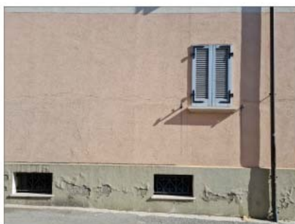
FOTO 07 - FRONTE LATERALE DETTAGLIO UMIDITA' ZOCCOLO
