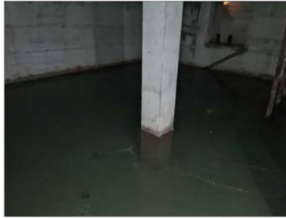
FOTO 38 - PIANO INTERRATO RISTAGNO ACQUA COPIOSO
