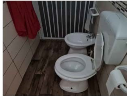
FOTO 41 - BAGNO NON CONFORME
