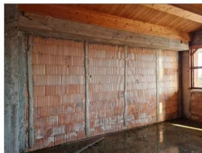
FOTO 30 - PIANO SECONDO RISTAGNO ACQUA SUL PAVIMENTO
