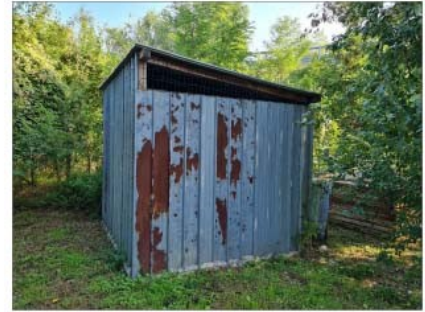
FOTO 21 - CAPANNO IN LAMIERA ABUSIVO
