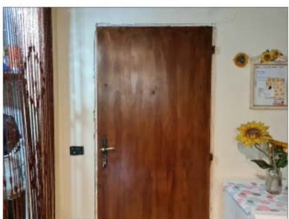
FOTO 49 - PORTA CENTRALE TERMICA
