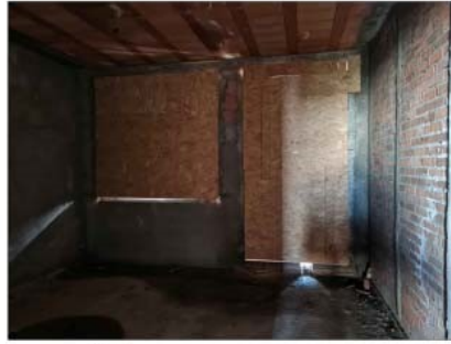
FOTO 23 - PIANO PRIMO APERTURE TAMPONATE LOGGIA SUL RETRO
