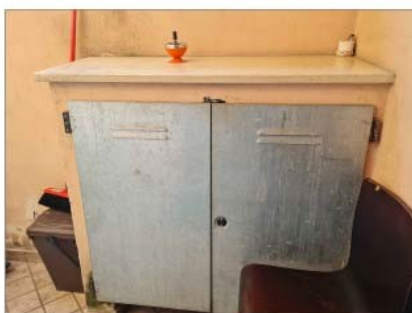
FOTO 14 - NICCHIA CONTATORI IMPIANTI
