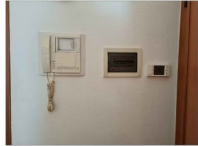
FOTO 48 - TERMOSTATO, QUADRO ELETTRICO E VIDEO CITOFONO
