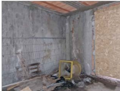
FOTO 20 - SUPERFICI GREZZE E APERTURE TAMPONATE
