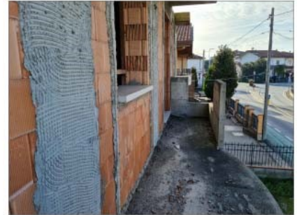
FOTO 27 - BALCONE PIANO PRIMO
