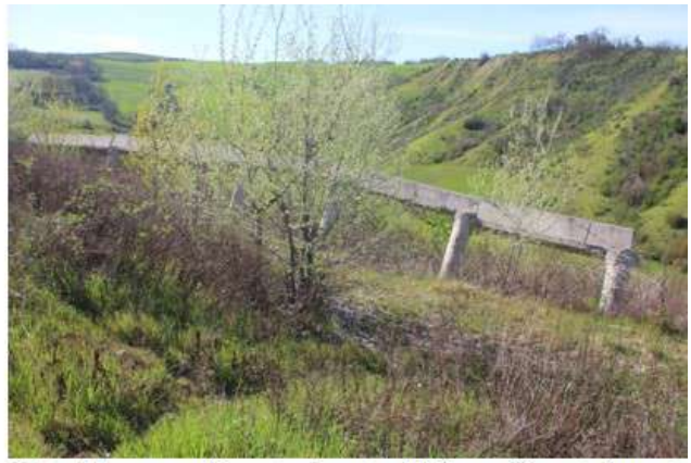
Foto 11: opere di contenimento dell'area di sosta franate
