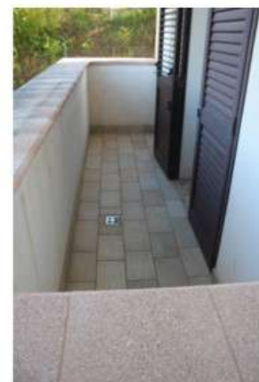
Foto 43: terrazzo con parte abusiva
