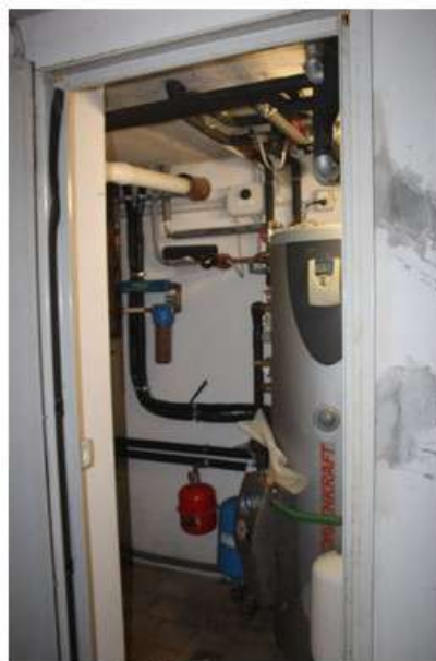
Foto 74: locale tecnico - interno
