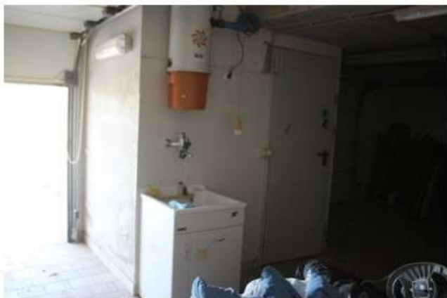
Foto 73: locale tecnico – esterno
