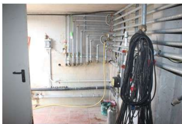
Foto 122: interno del locale tecnico
