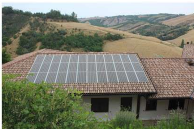
Foto 82: pannelli fotovoltaici in copertura agriturismo
