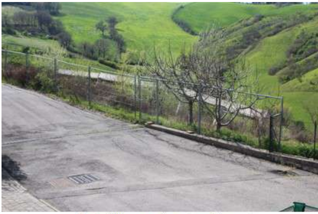
Foto 10: area di sosta collassata
