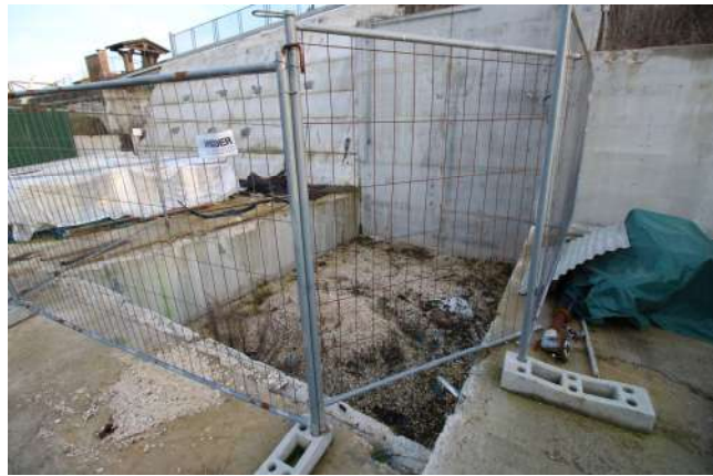
Foto 136: dettaglio fossa di carico materiale ligneo
