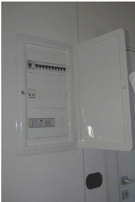
foto n.101 – quadro elettrico posto nel corridoio dell'appartamento, in prossimità della porta di ingresso
