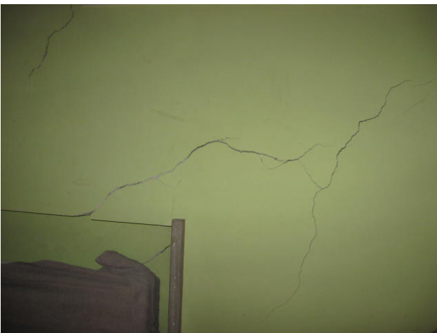
Crepe sulle murature
