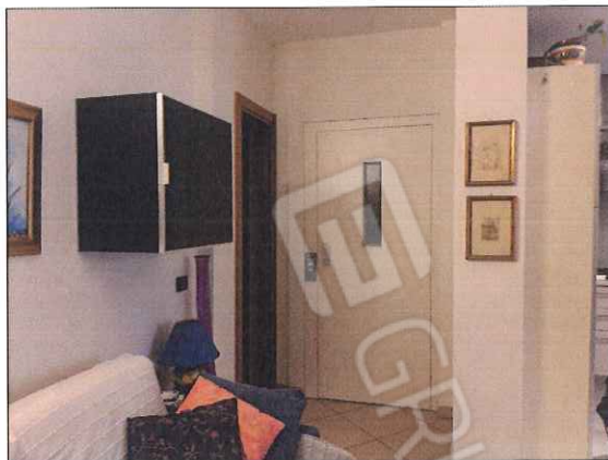
FOTO 21 - ASCENSORE A PIANO PRIMO
