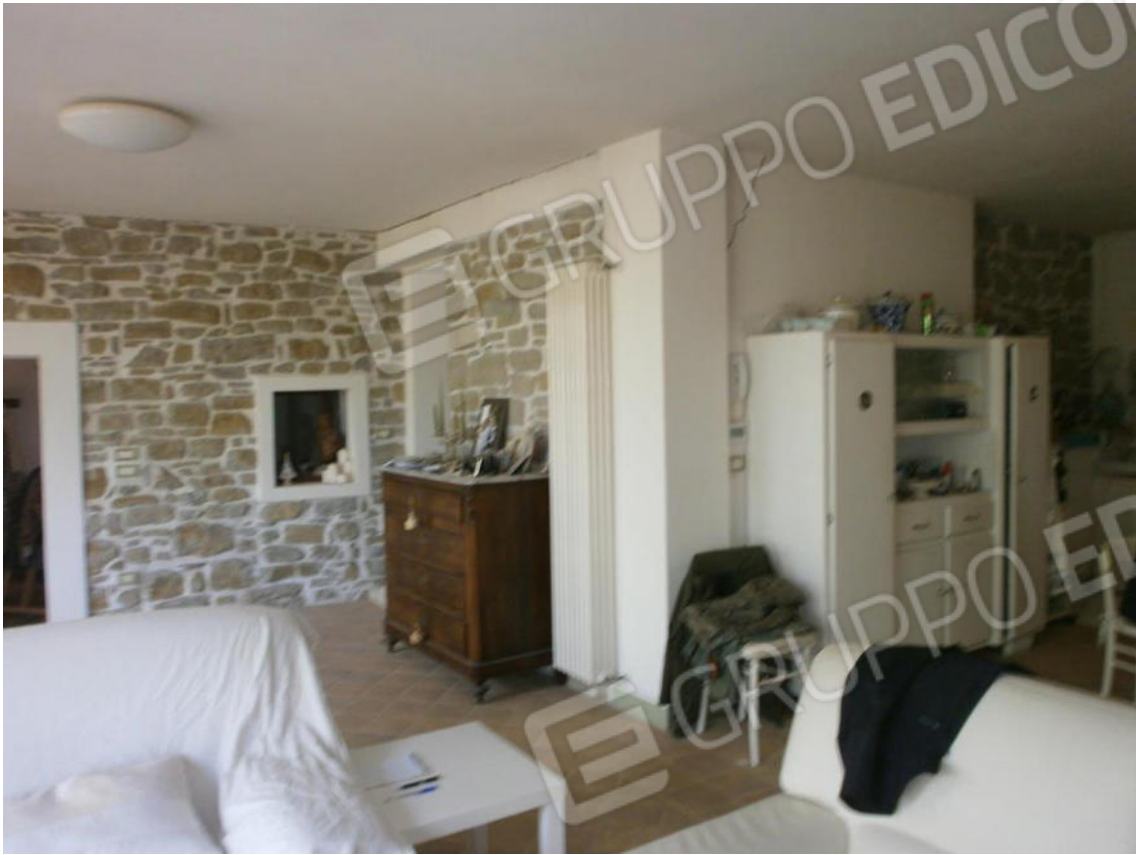
FOTO 11. Piano terra: salone con cucina, pranzo e soggiorno (spigoli con fessurazioni)
