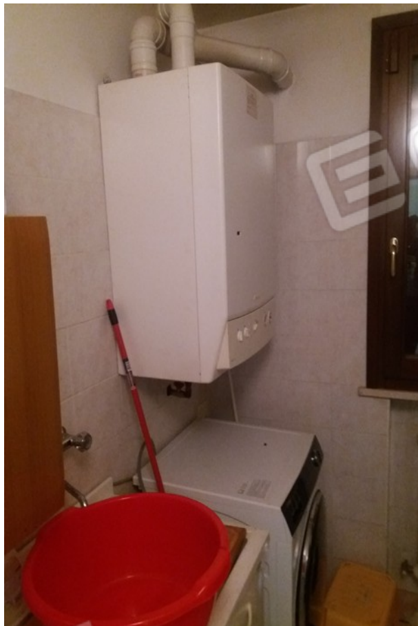
caldaia piano seminterrato
