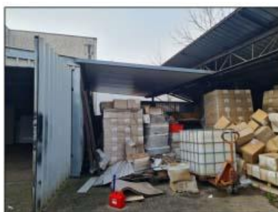
FOTO 11 - Tettoie abusive retro
