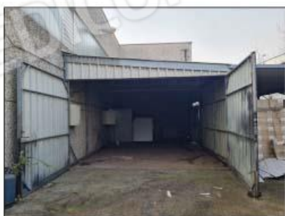
FOTO 10 - Tettoie abusive retro
