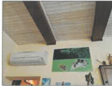
FOTO 50 - RAFFRESCAMENTO UNITA' INTERNA SPLIT
