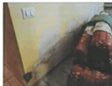
FOTO 63 - UMIDITA' DA RISALITA
