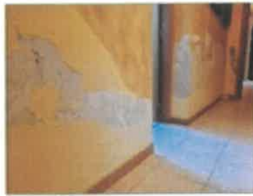
FOTO 65 - UMIDITA' E INFILTRAZIONI
