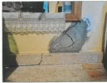
FOTO 59 - ASSESTAMENTI E UMIDITA'
