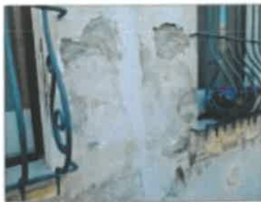
FOTO 55 - ASSESTAMENTI E UMIDITA'
