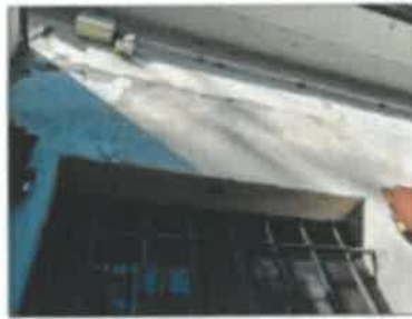
FOTO 56 - ASSESTAMENTI E UMIDITA'
