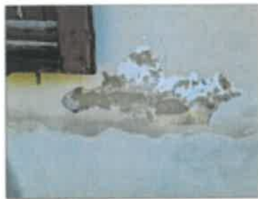
FOTO 58 - UMIDITA' E INFILTRAZIONI
