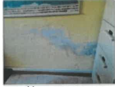
FOTO 66 - UMIDITA' E INFILTRAZIONI
