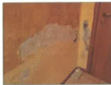
FOTO 64 - UMIDITA' DA RISALITA
