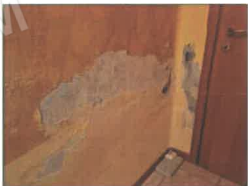
FOTO 64 - UMIDITA' DA RISALITA
