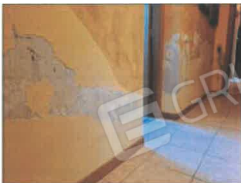
FOTO 65 - UMIDITA' E INFILTRAZIONI
