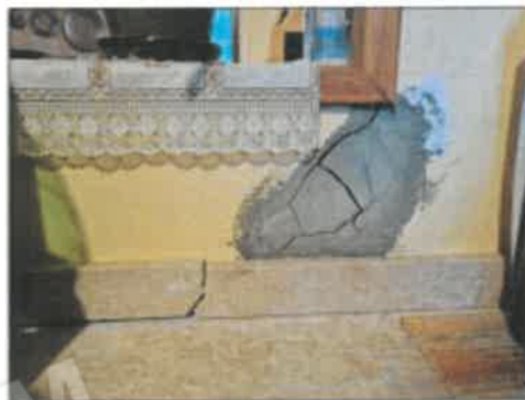
FOTO 59 - ASSESTAMENTI E UMIDITA'
