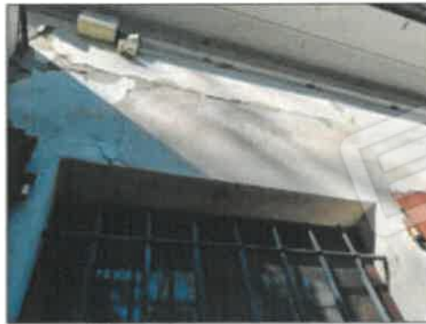
FOTO 56 - ASSESTAMENTI E UMIDITA'
