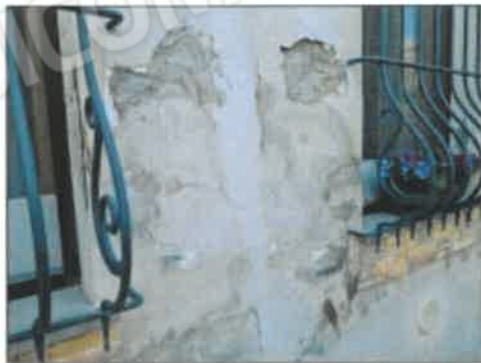
FOTO 55 - ASSESTAMENTI E UMIDITA'
