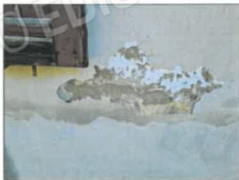
FOTO 58 - UMIDITA' E INFILTRAZIONI
